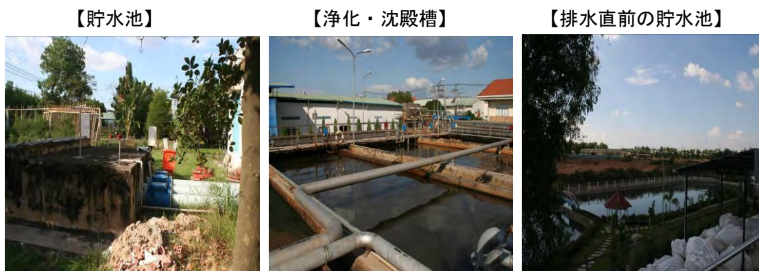
図 2-16 既存工業団地（LOTECO）における廃水処理施設の例
