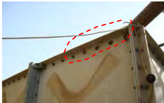
【西地区のガルブ浄水場・配水池】FRP パネルの接合ボルトが離脱し、破裂事故リスクに曝されている。本プロジェクトでは配水池を緊急改修する。
