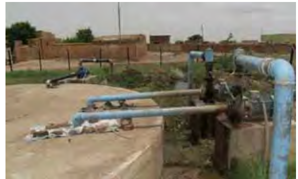
【ワオヌール増圧ポンプ場】市周縁部の送水のために市内には 5 カ所の増圧ポンプ場がある。写真は北部の増圧ポンプ場
