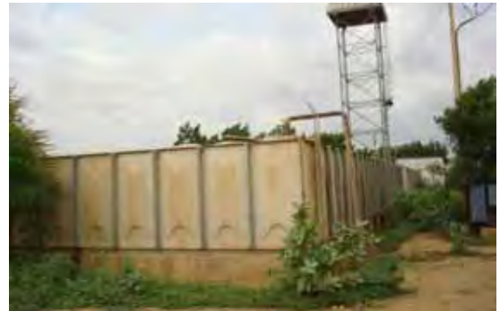
【西地区のガルブ浄水場・配水池】東地区のマハタ浄水場と同じ時期に建設された。老朽化が顕著である。
