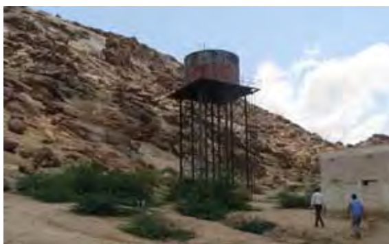
【ムクラム高架タンク】増圧ポンプ場からの送水を受け自然流下による配水するためのムクラム高架タンク
