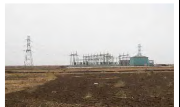
[送電プロジェクト] 「ス」国政府は東部州の電力事情の改善のため、中国の援助によりハルツームからの送電線工事を進め2011年7月には完成予定である。目標年次の2016年には対象地区の大幅な電力事情の改善が見込まれる。写真は完成した送電用変電所。
