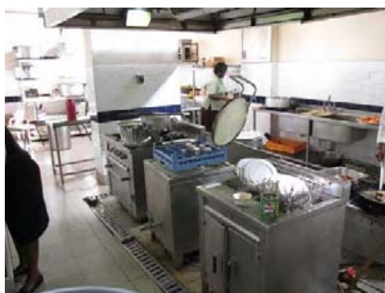
写真12. 既存厨房 写真5と同じく2004年改修。一部の機材が故障しているが、全般に状態は良く、継続利用可能。定員の増大に応じて機材の追加が必要。
