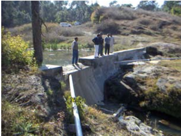
撮影日：2010年2月17日 場 所：ピラスプール県 内 容：RIDF 事業による MALAGAN 灌漑施設（取水施設は以前に完成していたが、配水施設は 2010 年完成）
