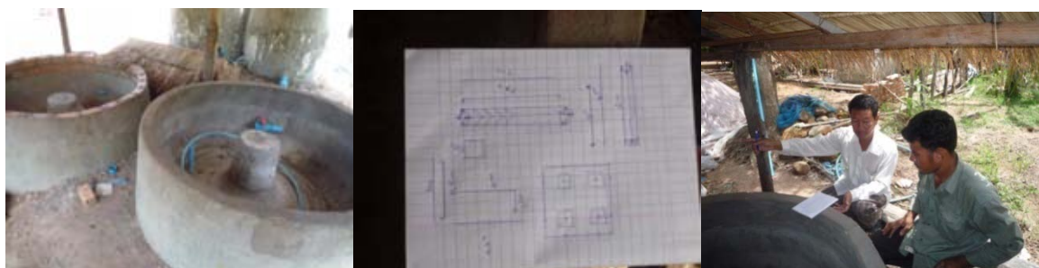
図 2 - 1 設計不備の施設を建設中の種苗生産農家（シェムリアップ州 Svay Sar Commune、Ou Village）。産卵タンクにも孵化タンクと同じような中央突起部がある（写真左）など、形のみ真似たと思われる孵化施設について、本調査訪問中に、図面（写真中央）を用いて改善指導を行っているシェムリアップ州 FiA 養殖部長（写真右）
