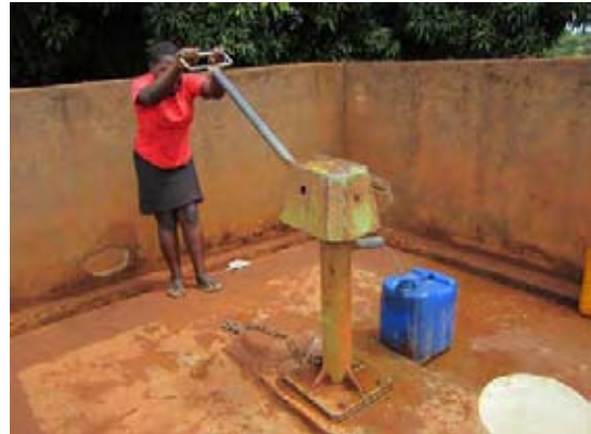
敷地に隣接してNGOにより整備された井戸。
