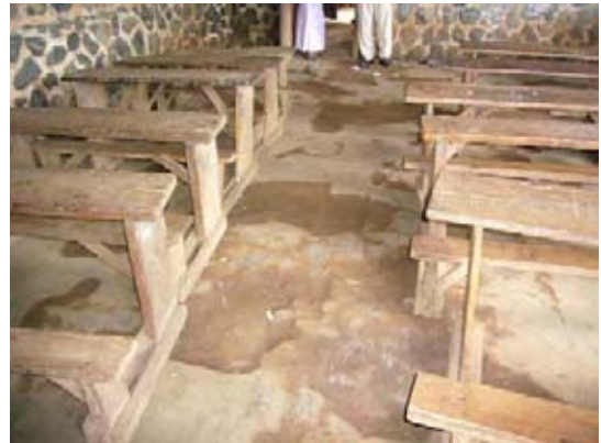
床にはコンクリートの剥離による凹凸が目立つ。
