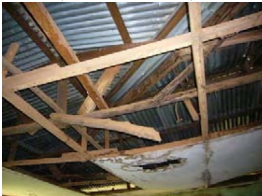
雨漏りの影響で、天井が崩落した室内。
