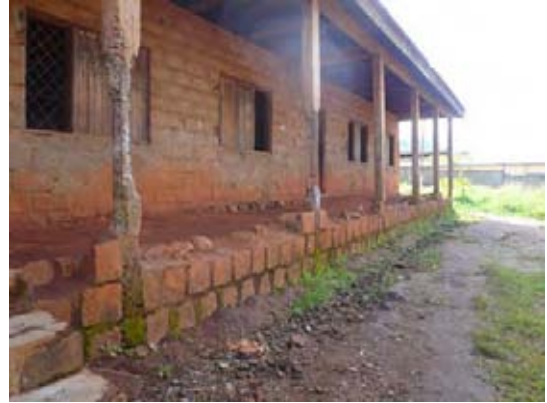
1958年に建設された施設は、既に老朽化が進み、柱は構造上の役割を果たしていない。
