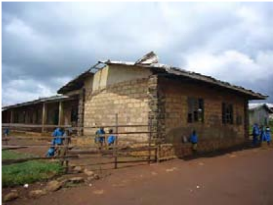
屋根が破損している教室も使用されている。
