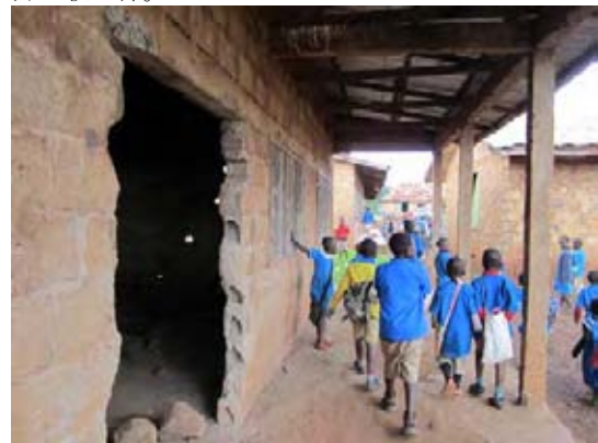
壁が崩壊して使用できない教室。
