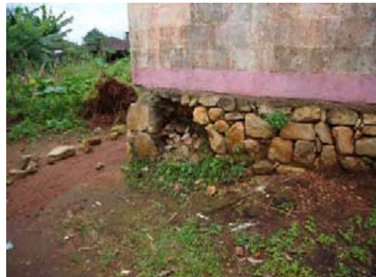
基礎の一部が崩壊し、構造上危険な状態。
