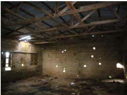
老朽化が進み、既に使用されていない教室。
