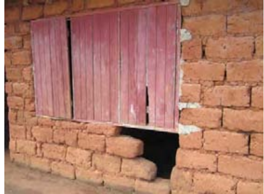
一部のレンガが抜け落ちている。
