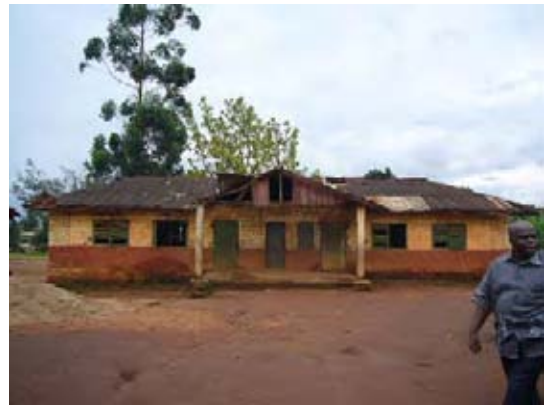
老朽化が進み、既に使用不可となった教室棟。
