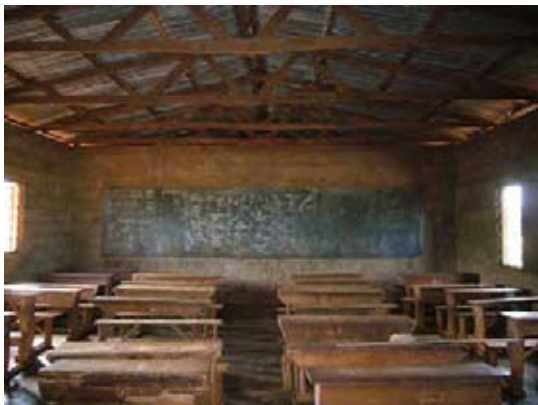
土間及び壁面のモルタル剥離が目立つ室内。
