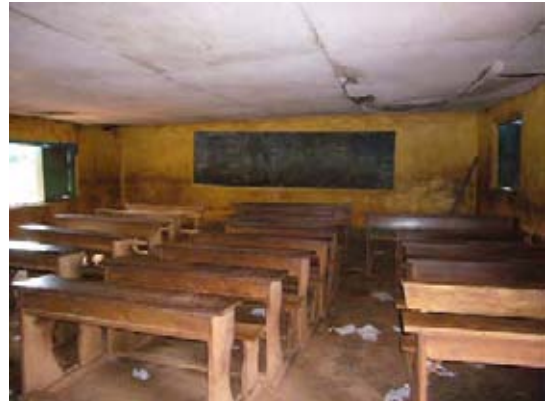
NGOによる教室内部。天井が大きく下がっているのが目視でも確認できる。
