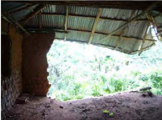
老朽化が進み、壁が崩壊したため使用不可能な教室。
