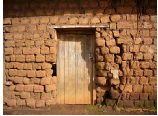
日干しレンガの校舎は壁が崩れかかっている。
