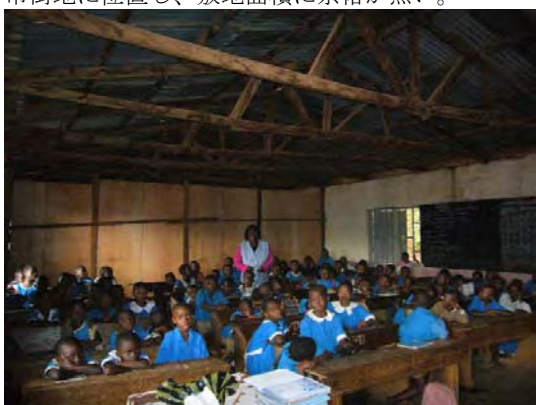
教室内は十分な照度が確保されていない。
