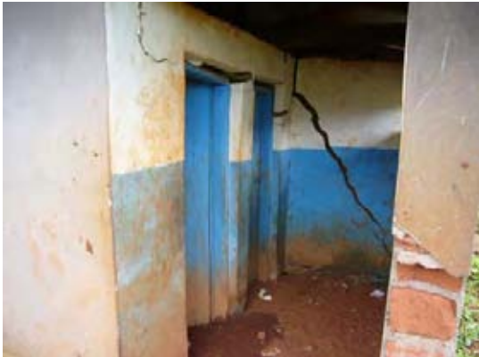
NGOにより2000年に建設された便所棟は、ブロック壁が下部の便槽に向かって崩壊している。非常に危険であり、使用されていない。
