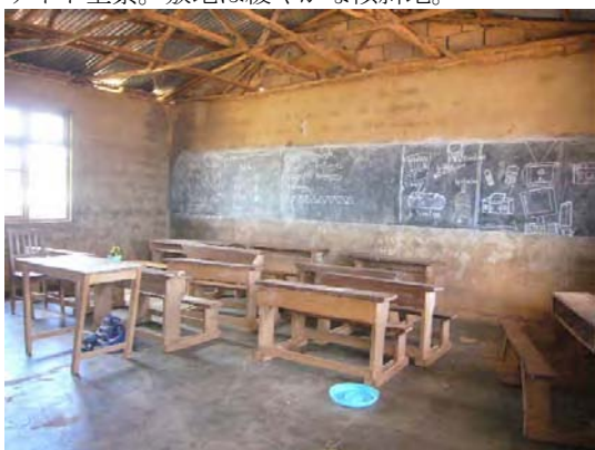
施設の老朽化が進んでおり、就学環境は悪い。
