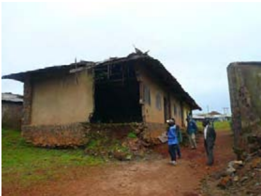
基礎が浸食され、壁が崩壊した校舎。
