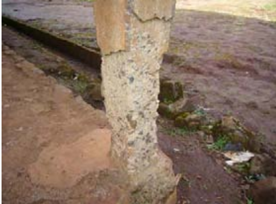
補強ブロック造の校舎は、柱、床のコンクリートが剥離している。
