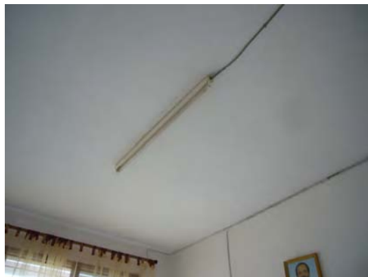
校長室には新たに電気設備が設置されている。
