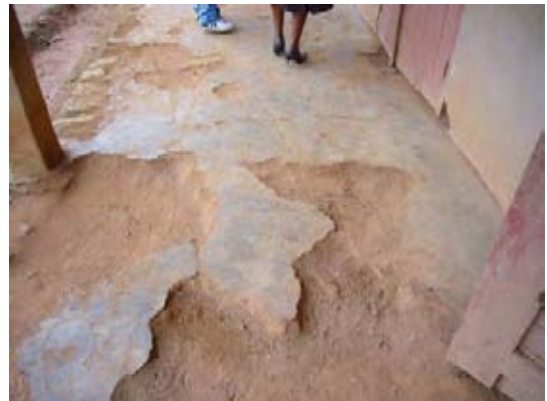
土間コンクリートの剥離が進行している。
