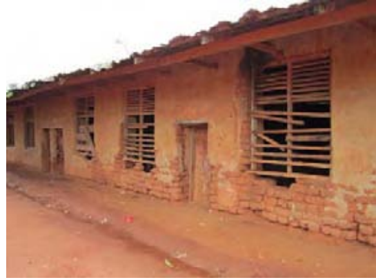
PTAにより建設された校舎は老朽化が著しい。
