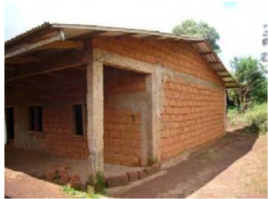
PTAにより2006年に建設された校舎。コンクリートの品質は劣悪。
