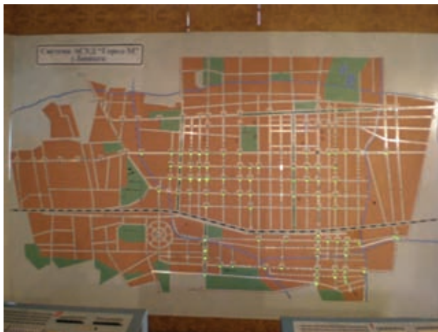
交通管制システム表示盤
