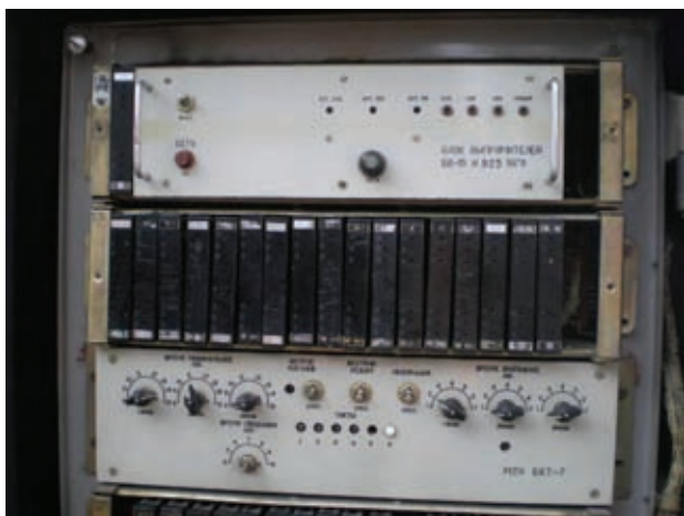
旧型信号制御盤
