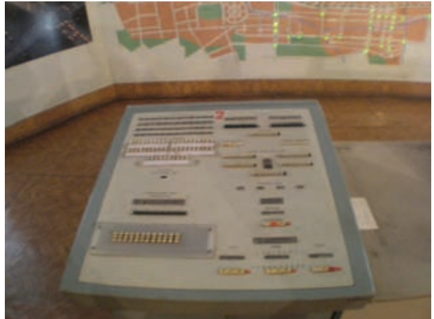
信号制御盤 (交通管制室/機材据付局内)
