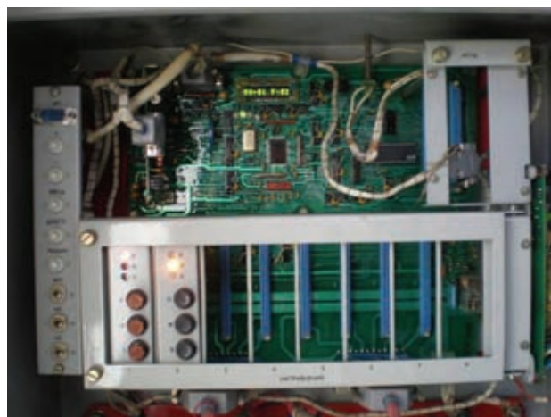
新型信号制御盤
