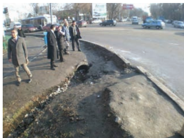
未舗装で排水構造物も整備されていない歩道
