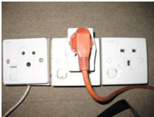
写真-13：ACコンセントはB3型(左側)とBF型(右側)が併設されている。
