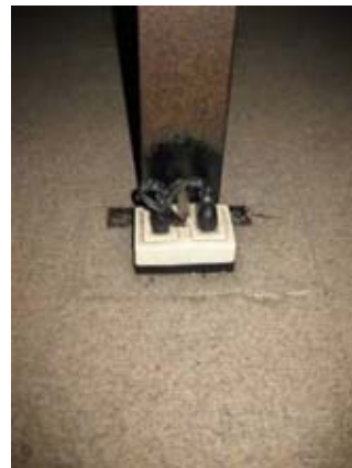
写真-12：学生用機の電源コンセント（AC100V）。カーペット下に配線されている。新規LLシステム導入時にはカーペットを撤去する必要がある。
