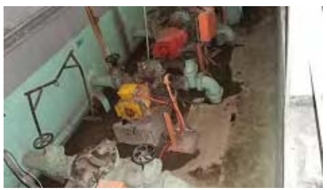
使われていない送水ポンプ
