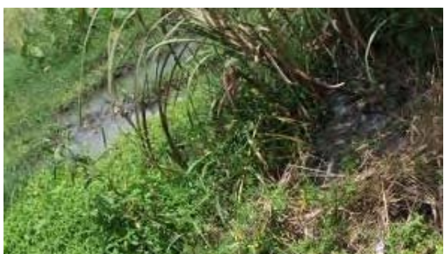
⑫下水管漏水箇所
