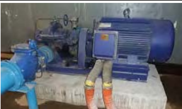
チフブ配水池への送水ポンプ
