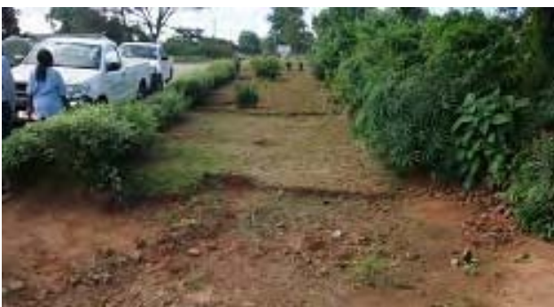
⑩-2 ノースライズ配水池からの配水管理設箇所
