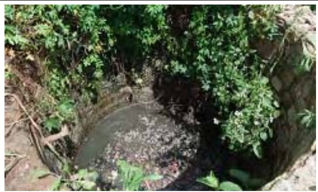
⑫下水管閉塞による人孔溢水箇所
