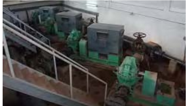
チフブ配水池への送水ポンプ
