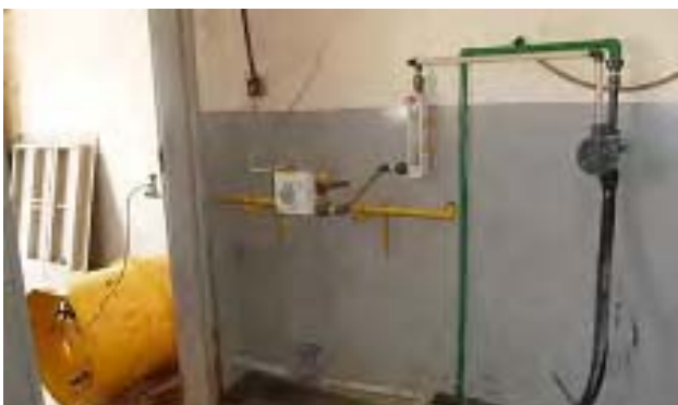
塩素ガスタンクと注入配管
