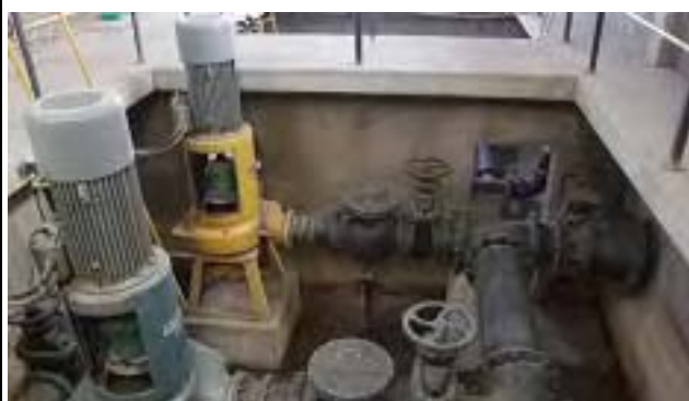
⑪-2 汚泥搬送ポンプ
