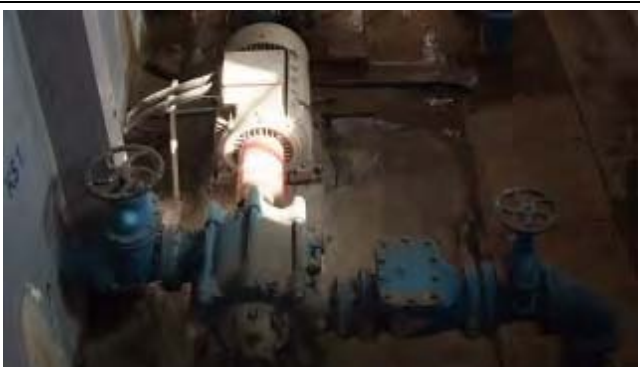
カンセンシ配水池への送水ポンプ
