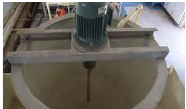
凝集剤攪拌機 使われていない
