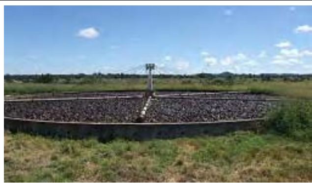
⑩-1 散水濾床槽
