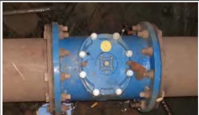
⑩-1 配水池からの配管の水量計（動作不能）
