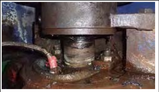
⑥KSB社製ポンプ 振動と軸封部の漏水が激しい
