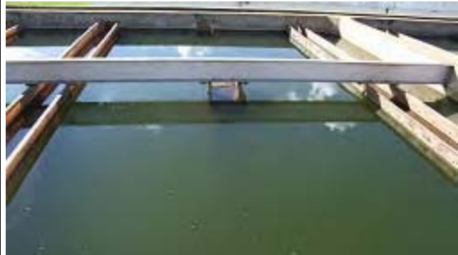
③折れたグラスファイバー製トラフ（中央）
