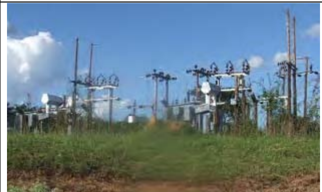
高圧受電設備
