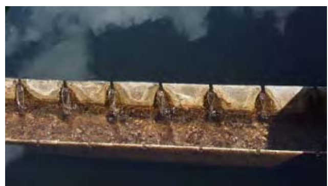
沈殿池の集水トラフ
