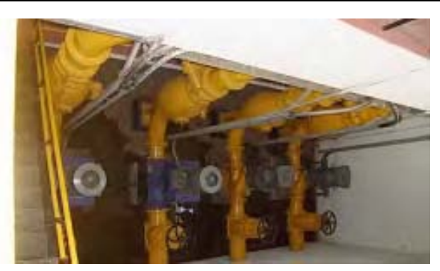
①取水ポンプ 全 7 台のうち 4 台
