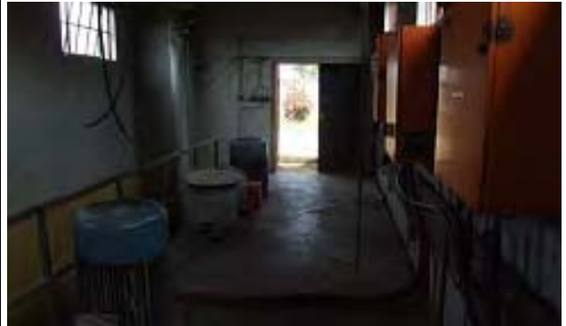
⑬地階に配置された立軸ポンプの電動機3台
