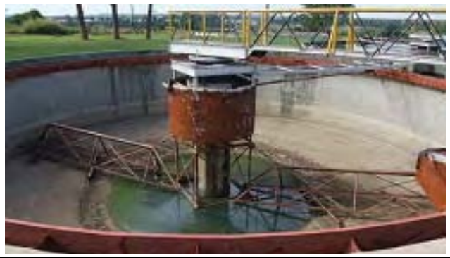
⑪-2 使われていない最初沈殿池 底部に汚泥掻寄機
