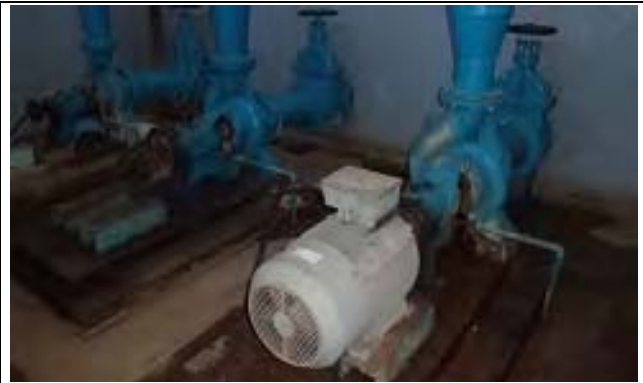
濾過池逆流洗浄ポンプ
