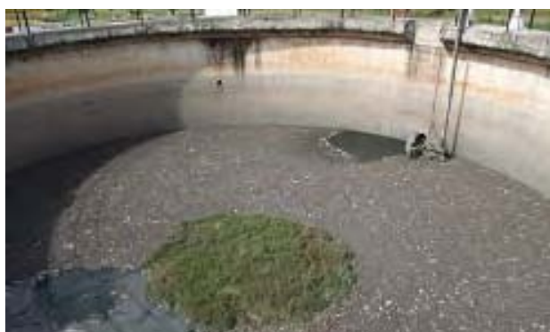
⑪-2 好気性消化槽
