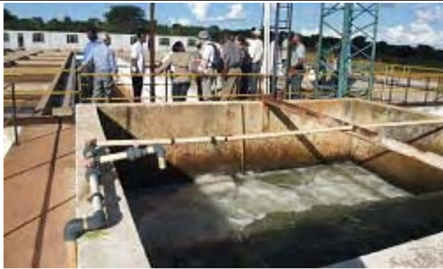
凝集剤滴下配管と迂流式の薬品混和槽
