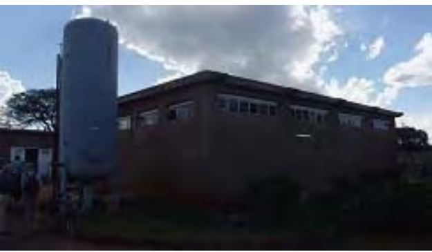
送水ポンプ場と圧力タンク
