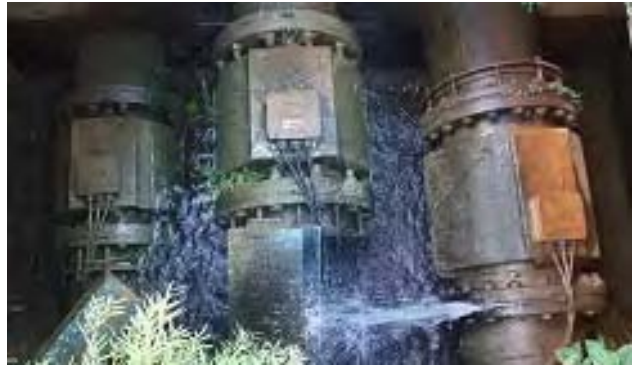
集水井への配管に設置された水量計（動作不能）
