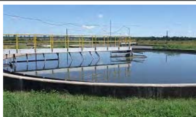
⑩-1 最初沈殿池
