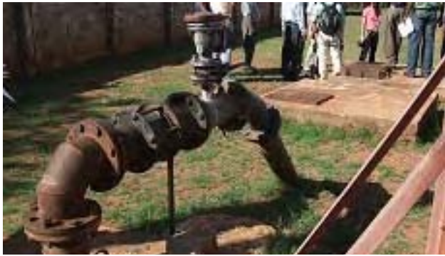
ミスンドゥ I 系統の送水ポンプ場内にある取水井
