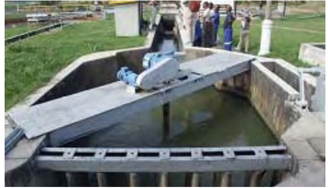
⑪-2 流入部の凝集剤攪拌槽 (利用状況不明)
