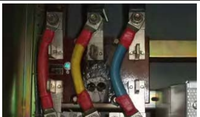
受電盤内 断路器の焼損後、直結配線してある
