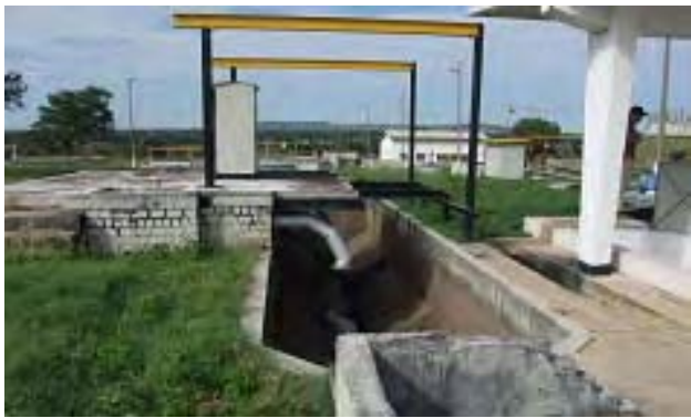
⑪-2 ルフト下水処理場へのバイパス送水管
