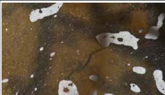
急速濾過池 濾過砂表面に亀裂が生じている
