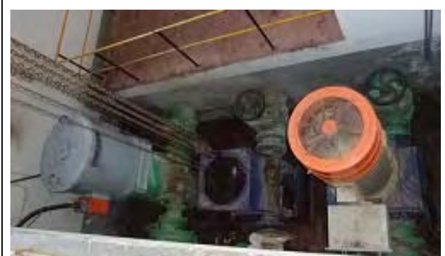
⑥送水ポンプ7台のうち3台
