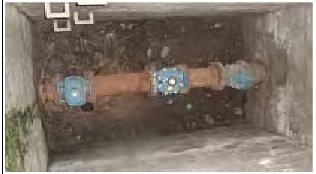
配水池の流出側に水量計が2系統あるが動作不能
