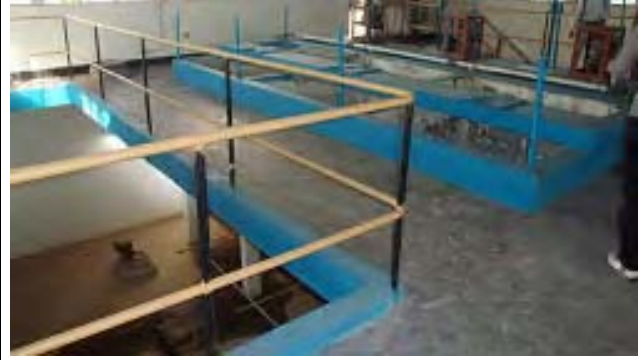
②1階：攪拌槽、地下：薬品注入・搬送ポンプ室
