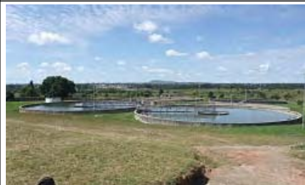
⑪-2 最初沈殿池
