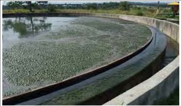
⑪-2 最終沈殿池 水面に藻類が繁茂している
