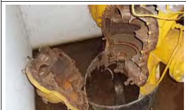
①補修のため分解されたままのポンプ
