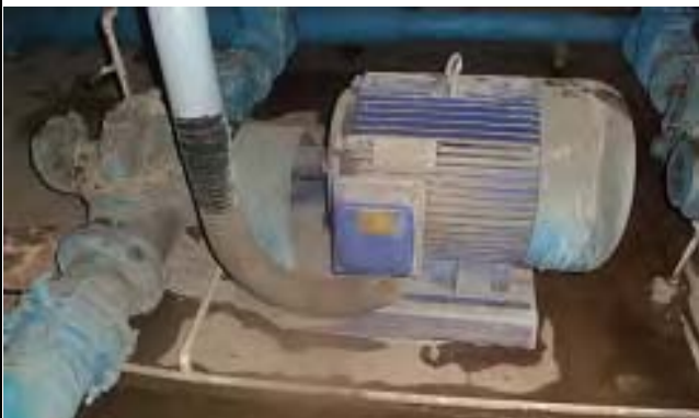
ブワナムクブワ配水池への増圧ポンプ
