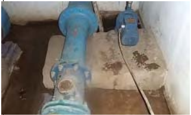
増圧ポンプ吐き出し側の水量計も動作不能
