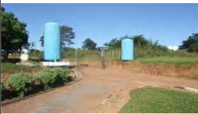
送水管の水撃防止用圧力調整タンク
