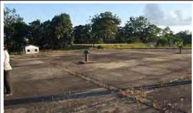
カンセンシ配水池と使われていない増圧ポンプ場
