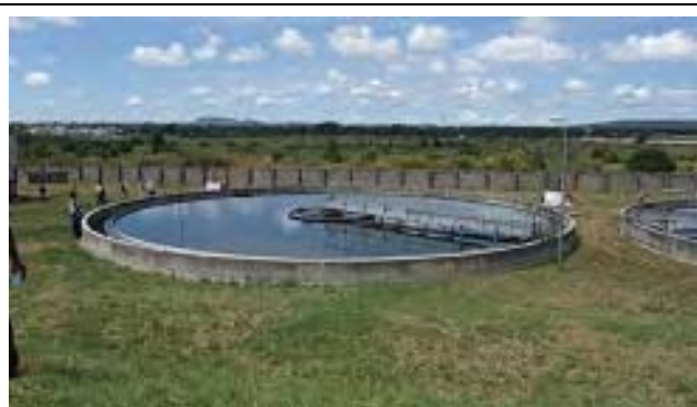
⑪-2 最終沈殿池
