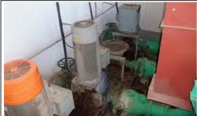
⑥送水ポンプ7台のうち4台
