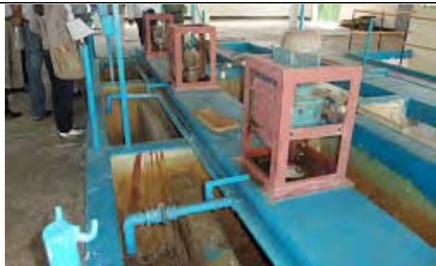
②攪拌機が故障し、凝集剤が使用されていない
