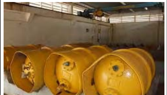
塩素ガス貯蔵設備
