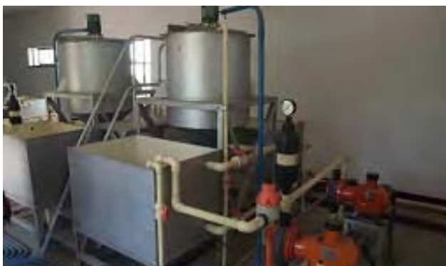
イタワ浄水場の薬品攪拌槽と注入ポンプ
