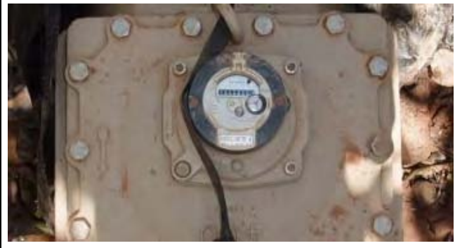
DTF 資金により水道公社が設置した大口径水量計
