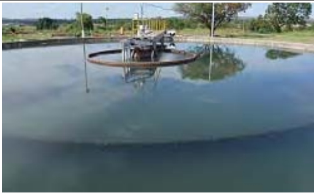
⑪-2 最終沈殿池
