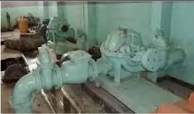
カンセンシ配水池への送水ポンプ
