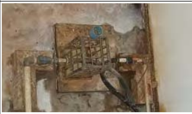
②薬品注入ポンプは取り外されている
