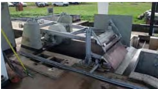
⑪-2 自動除塵機
