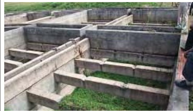
⑪-2 使われていない砂濾過槽 (高度処理用)
