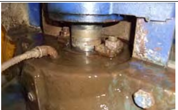
①KSB 社製ポンプ 軸封部の漏水が激しい
