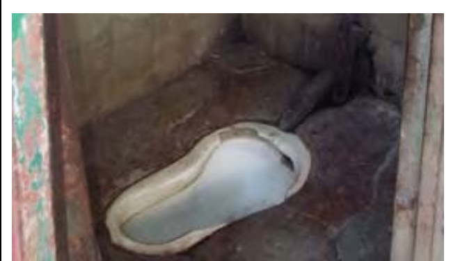
マサラ地区の民家の水洗便所（配管は壊れている）
