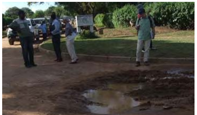
⑩-2 コンクリート配水管からの漏水
