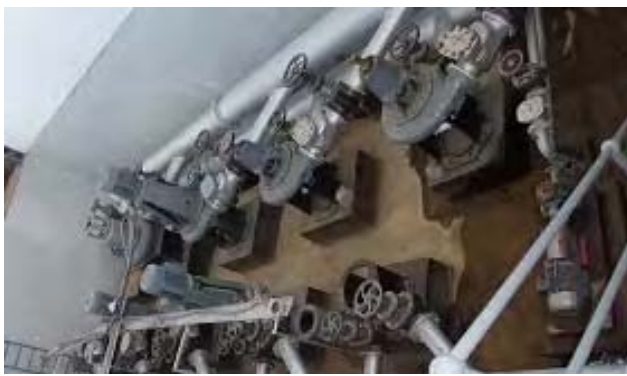
⑪-1 汚泥搬送ポンプ
