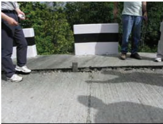
PII-3 Sta.11km+500 谷川盛土部分の圧密沈下による舗装面の変形。継続観察が必要であるが、現状では問題なし。
