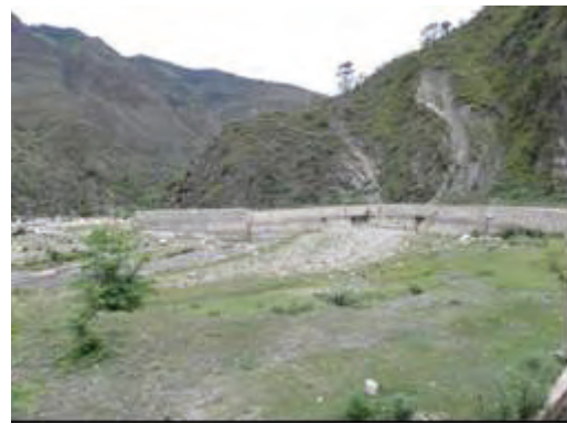
PIV-6 STA18+900 過去の河川浸食箇所 現在は復旧済み
