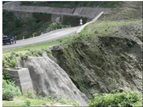
PII-4 STA17+400: 細尾根を通過する区間。東側斜面は断層で破碎された脆弱な岩石で構成される急斜面となっており、放置すると崩壊が進み道路が消失する恐れがある。崩壊防止の応急処置と恒久的な対策が必要である。
