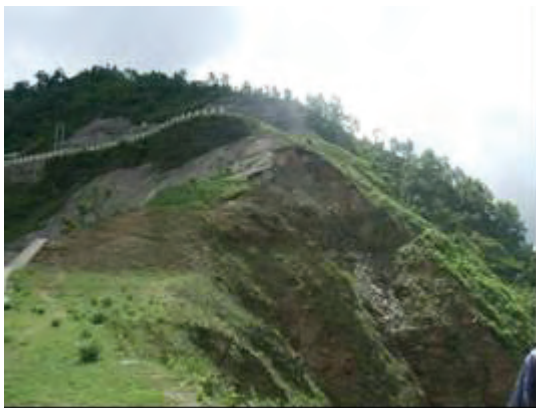
PII-5 上部はSTA18+500のヘアピンカーブ。2005年9月に幅30m、長さ50mの崩壊が発生。その後も拡大の兆候が認められる。下部の急斜面はSta.17km+400東側の急斜面に連続する。応急対策と恒久対策が必要である。
