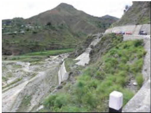
PIV-5 STA23 水衝部の災害箇所 護岸工が施工済み
