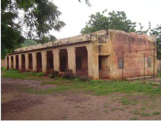
写真-1：バマコ特別区（左岸）の Samé 校 政府仕様の建物であるが老朽化が進んでいる。
