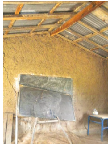
写真-10：カイ州（キタ）Kabé 校 住民の自助努力により建設された日干し煉瓦造教 室内部の様子。壁に亀裂が入り、非常に危険な状態。
