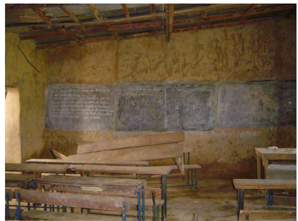
写真-6：クリコロ州（カティ）SongonII 校 住民の自助努力により建設された校舎内部。黒板も 粗末で、建物は老朽化が進んでいる。
