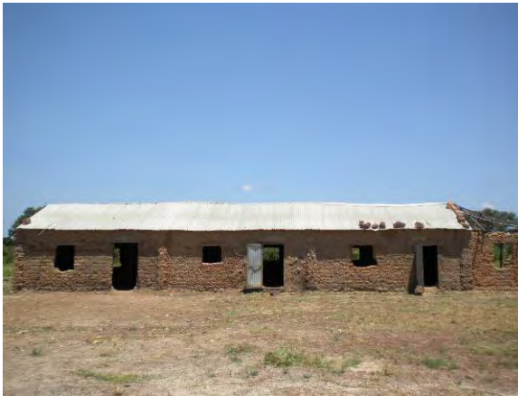
写真-9：カイ州（キタ）Kouléko 校 住民支援により建設された日干し煉瓦造の 3 教室 校舎。教育環境としては劣悪で使用不可能。
