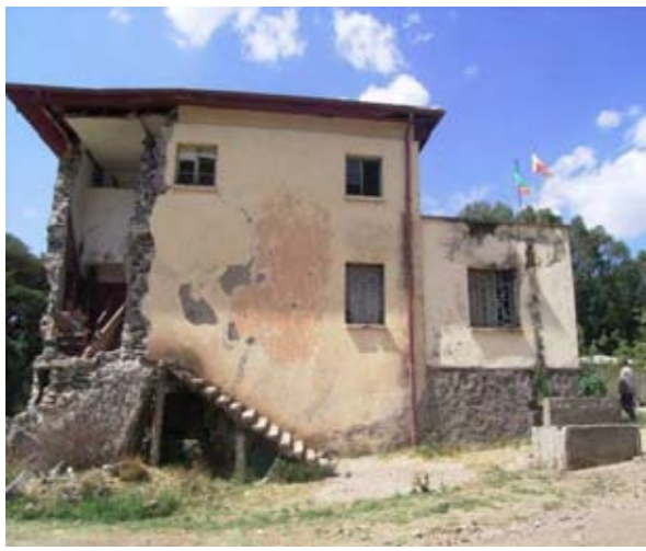
GD-12: ゴンダール市ファシラダス中等学校(崩壊した校舎の一部。同校の恒久教室数は全体の3分の1程度)
