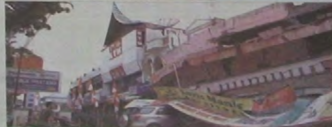
Bangunan kompleks Pasar Raya Kota Padang nyaris ambruk.
