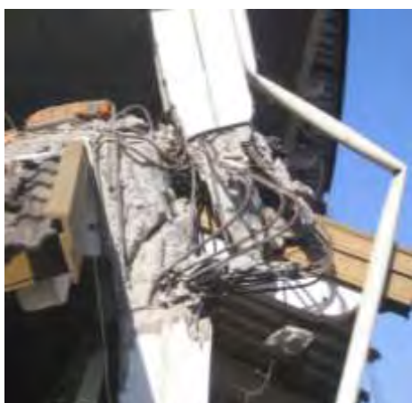
図-88: 柱梁の崩壊
