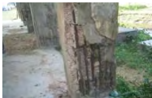
図-3 塩害による柱の損傷
