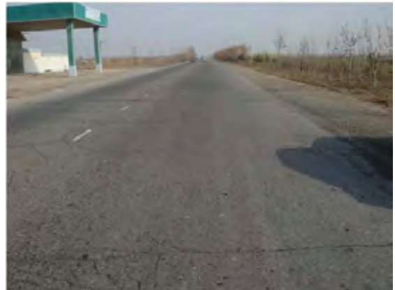
写真-4:既存舗装の状態(46.9km) 舗装面クラックは横断方向が卓越している。
