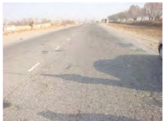
写真-6:既存舗装の状態(42.8km地点) 舗装全面にクラックが生じパッチング程 度の軽微な補修での対応は不可能。
