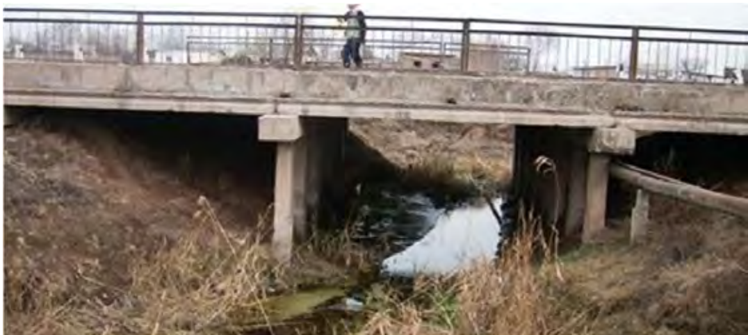
写真-8: 橋梁No.3 上流側全景（橋梁No.3, No.4 およびNo.5は床版鉄筋の露出・部材断面欠損等が観察され、架け替えの必要が認められる。）
