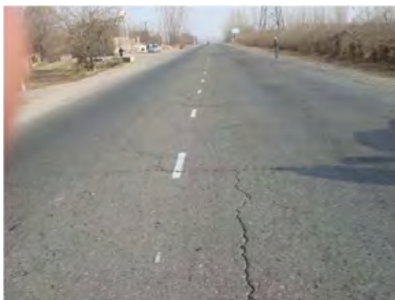
写真-5 : 既存舗装の状態(44.9km) あるパターンの繰り返しのような舗装面 クラックが観察される。
