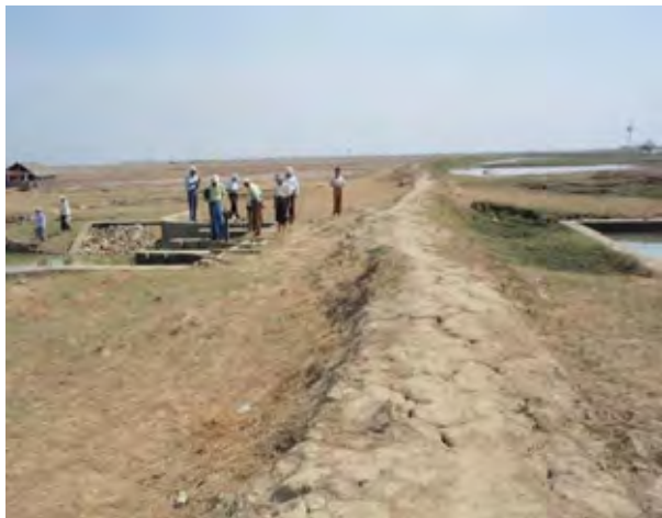
輪中堤防の緊急盛土の状態（雨季に行われた工事のため亀裂が多く見られる）
