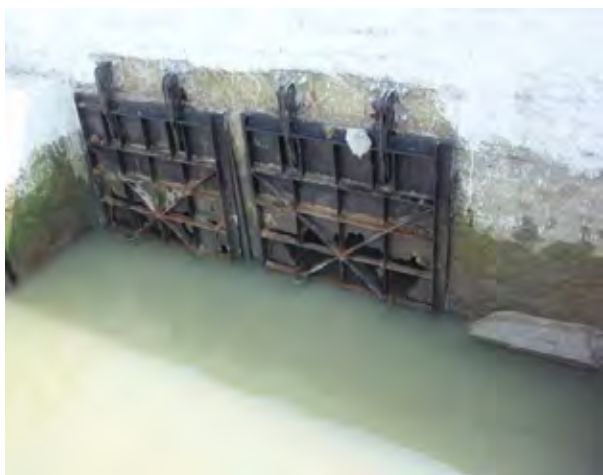
ミ国製鋼鉄製フラップゲート（汽水のある河川側にあるため腐蝕が激しい）
