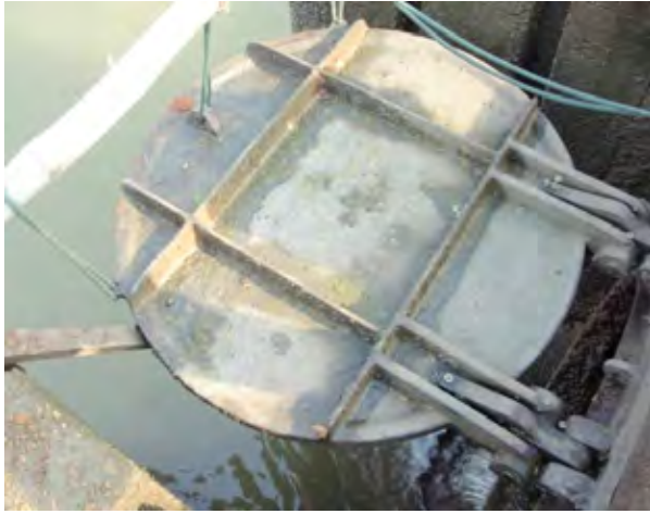
水門輪中側スライドゲート (サイクロンにてシャフトと台が損傷した状態)
