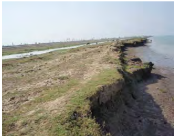
サイクロンによって洗い流された輪中堤防（右側の水路は緊急盛土の土採取後地）
