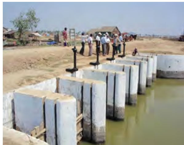
Kyonekaw 輪中側スライドゲート（8門のゲートの内、外側4門が角落し構造）
