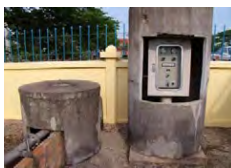
写真 8: SRWSA 生産井戸 (PW-4) およびコントロール・ボックス
