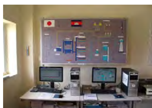
写真 6: コントロール室 (SRWSA 井戸運転状況管理)
