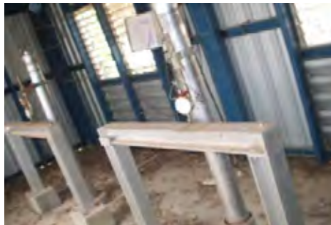
写真 10 : 地盤沈下・地下水水位 観測装置
