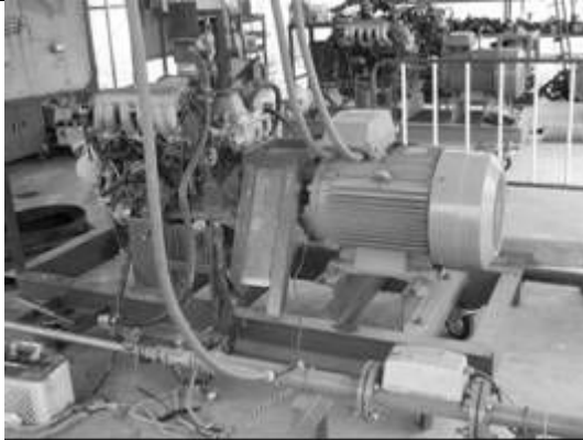
写真 4.2.11 消化ガス発電機 (トラックエンジン・モーター直結)
