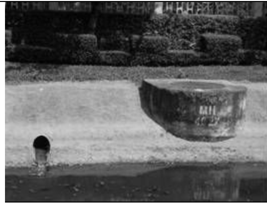
写真 3.6.2 遮集管近傍の未処理下水
