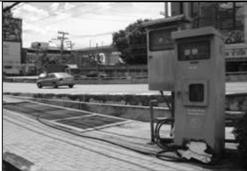
写真 4.2.7 既存のマンホールポンプ ( Phetchaburi 通り沿い )
