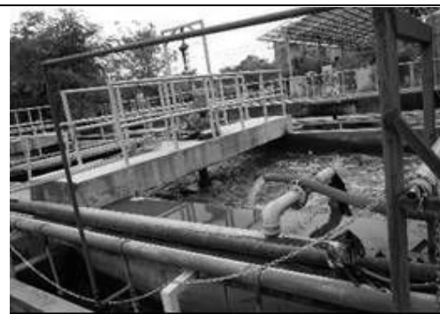
写真 3.4.12 反応タンク(流出部へ生石灰投入)
