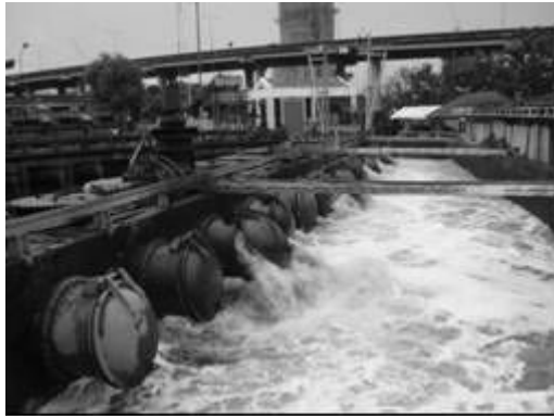
写真 3.4.1 Phra Khanong ポンプ場
