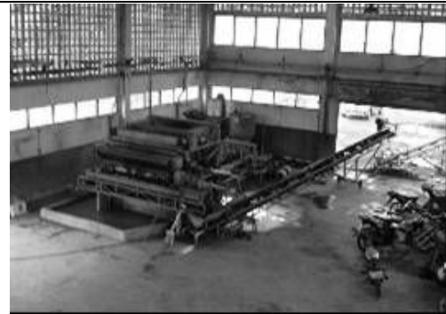
写真 3.4.16 ベルトプレス汚泥脱水機
