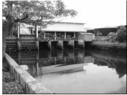
写真 3.4.2 Chong Nonsi ポンプ場
