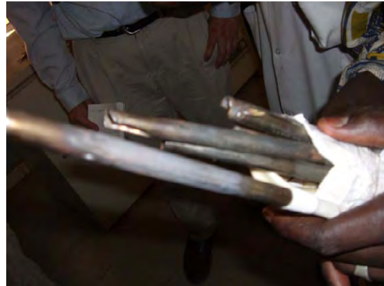
写真-8: 電気・灯油式冷蔵庫 過電圧によりヒーターがしばしば焼損するため、電圧安定器 が必要である。
