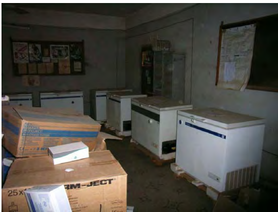
写真-9: カイ州保健局ワクチン倉庫内部 どの冷蔵庫も満杯の状態ので容量の大きい冷蔵室を入れる必 要がある。
