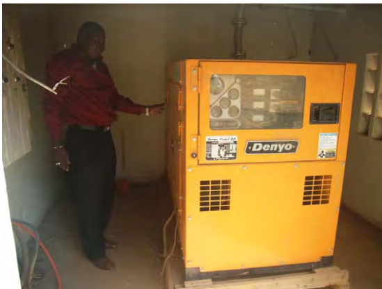
写真-5:非常用発電機 月に2~3回の頻度で停電が起こるので、冷蔵室の非常電源として不可欠である。
