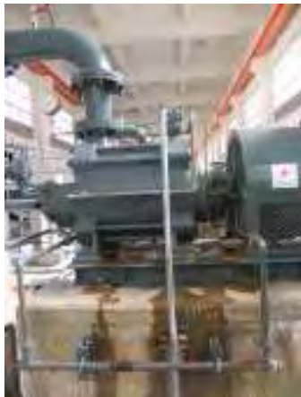
水漏れが発生しているポンプ
