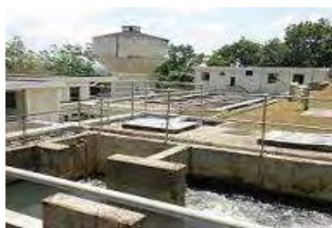
マリンバダ浄水場着水井
