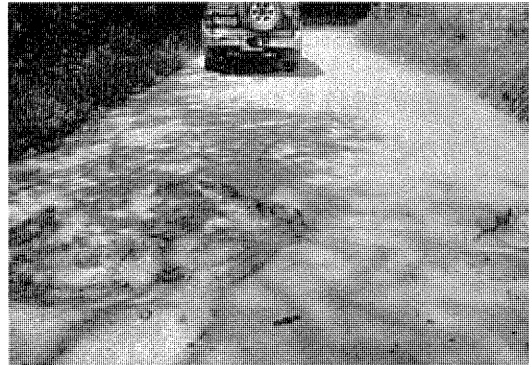
水道管の設置により被害を受けた道路
