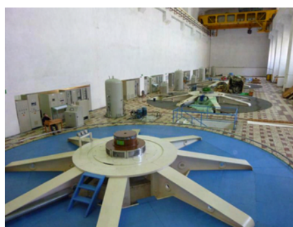
図3 発電機ユニット (フィエルツア発電所)
