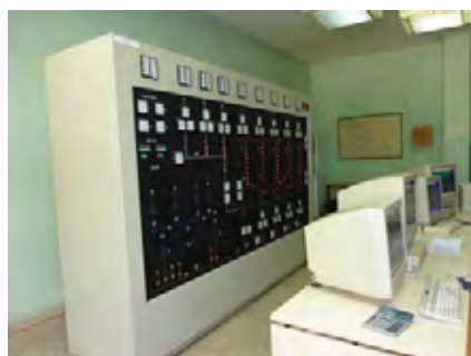
図8 コントロール・ルーム (フィエルツァ発電所内)
