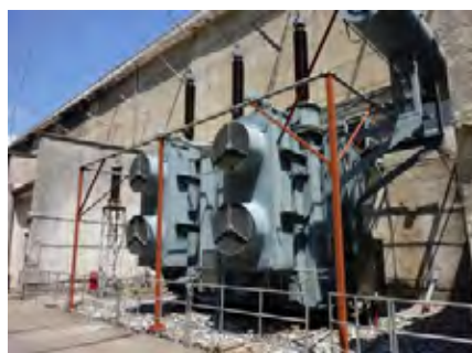
図9 昇圧変圧器 23 (フィエルツァ発電所建屋に隣接)
