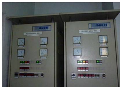
図 7 円借款リハビリ対象の電気装置 (バウイデジャス発電所)
