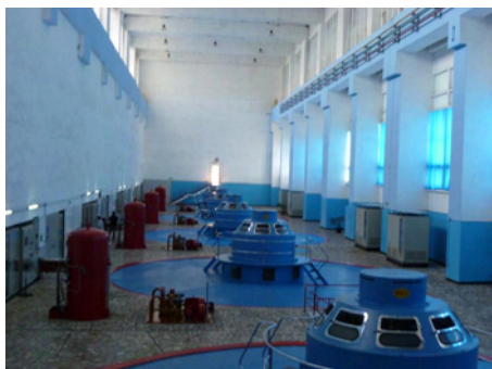
図4 発電機ユニット (バウイデジャス発電所)
