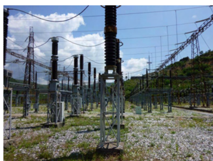
図2 変電所内220kV断路器 (フィエルツア発電所)
