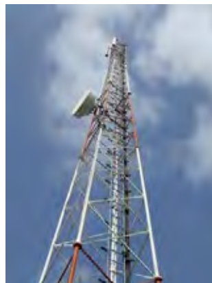
ワイヤレス・ローカル・ループの通信塔
