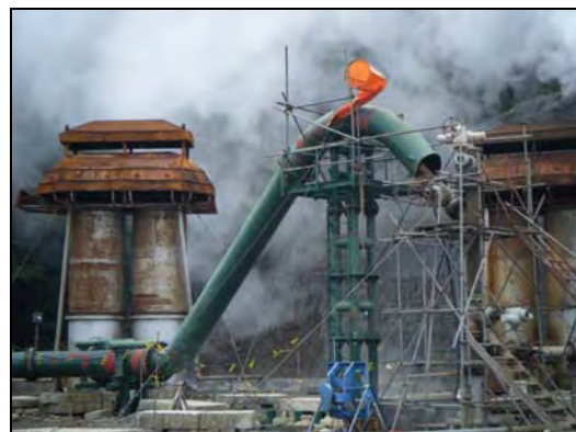
写真1：現在開発中の蒸気井
