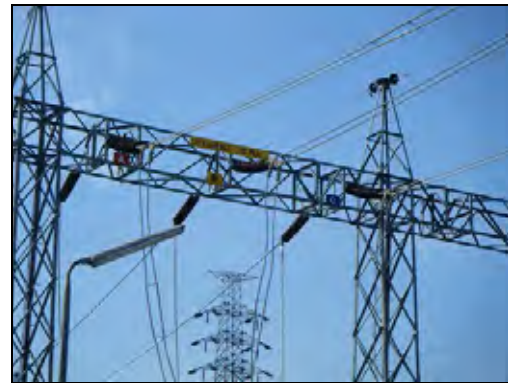
本事業で建設された 115kV 送電線
