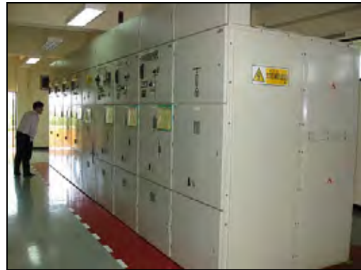
本事業で支援を行った変電設備
