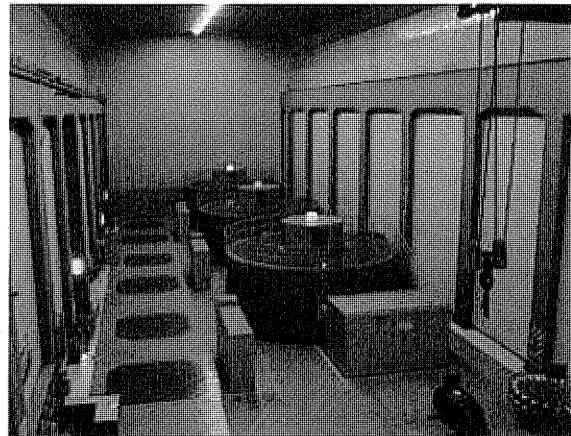
ユンカン水力発電所 (地下発電施設)
