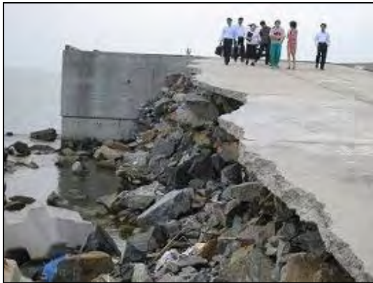
破壊された防波堤
