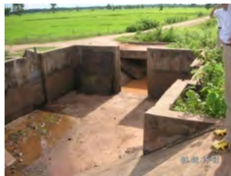
分水工／左右への支線水路へ分水
