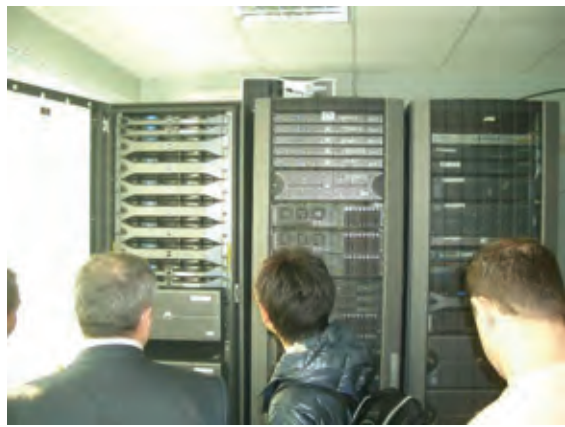
政府系機関のサーバールーム
