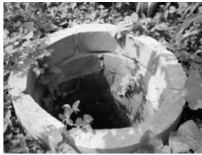
世帯内の DLV2 槽目 (蓋/防護が無く危険)
