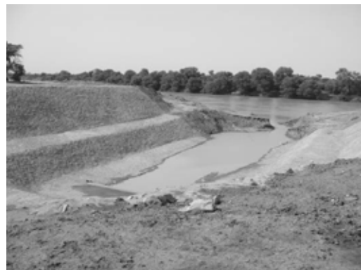
セネガル川からの揚水施設
