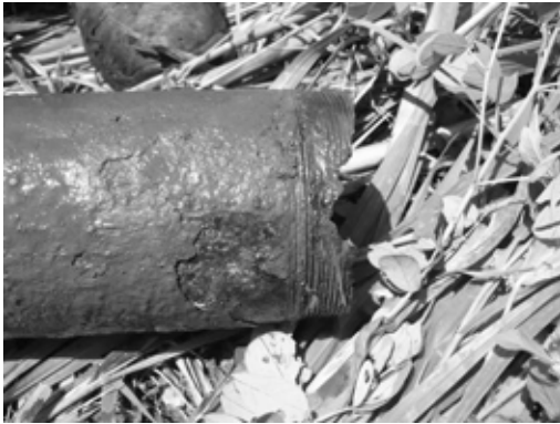
揚水管の腐食
