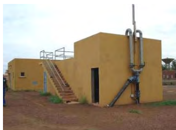
構内の浄水棟(除鉄プラント)
