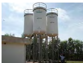
中継ポンプ場
