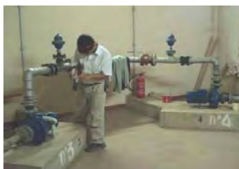
ポンプ室(高架水槽へ送水)
