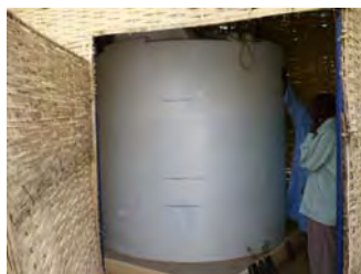
処理水貯水タンク
