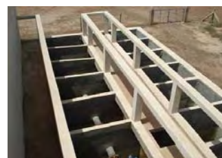
浄水場の曝気槽
