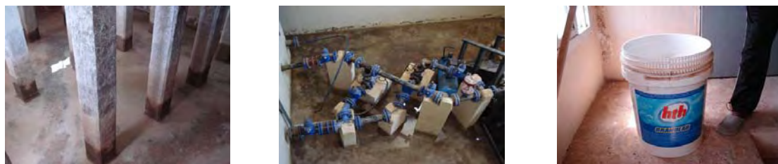
浄水棟内部の貯水槽
