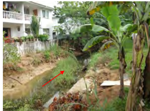
右岸側の河岸が侵食されているため、土嚢で補強している
