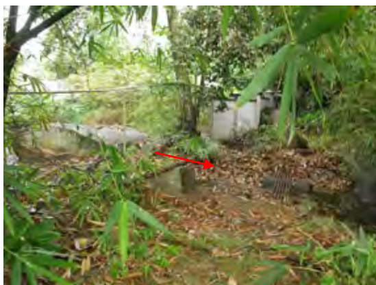
隣の家との境界に作られた金網が川を阻害
