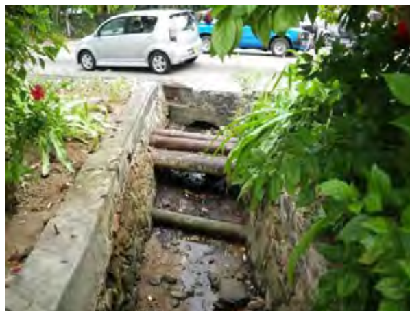
流水を阻害するパイプ類
