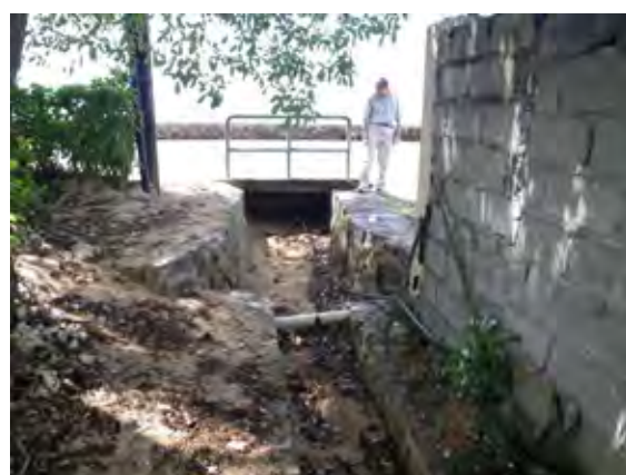
道路下のカルバートは砂が堆積して閉塞
