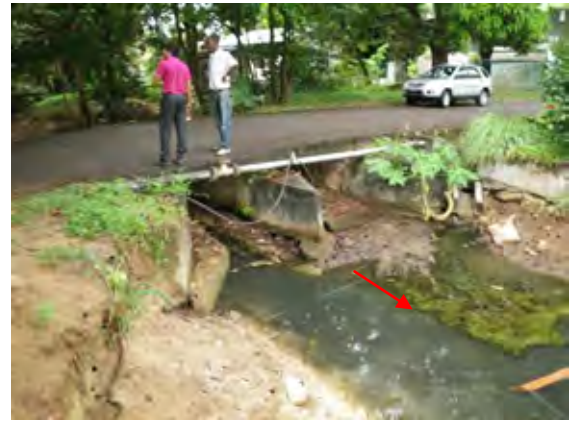
右岸側が侵食されている
