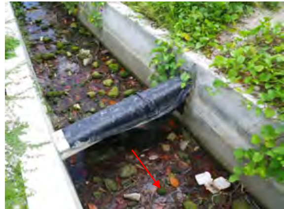
排水路内にある通信会社のケーブル
