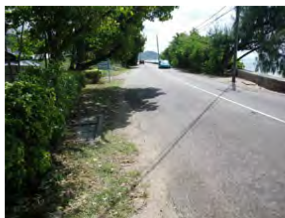
海岸道路の排水路、一部土砂が堆積
