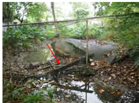
金網にゴミが引っ掛かって流れを阻害する
