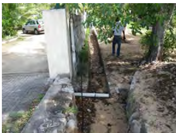
海への出口の流路。土砂が堆積している。
