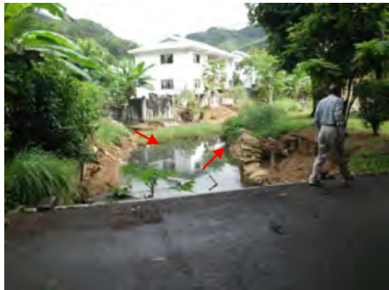
住宅地の中を流れる川。橋の付け根の河岸が侵食されている。左手から来た川（排水路）と合流している。
