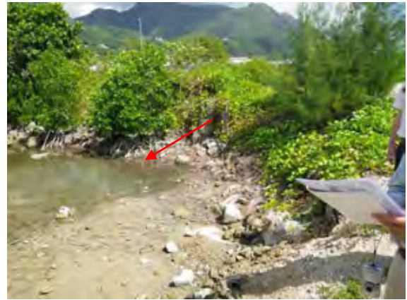
下水の排水パイプがリーフに流入
