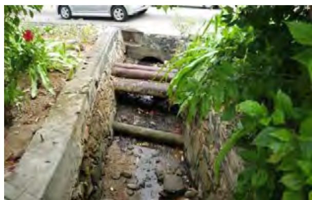
写真6 流水を阻害するパイプ類 (ビクトリア)
