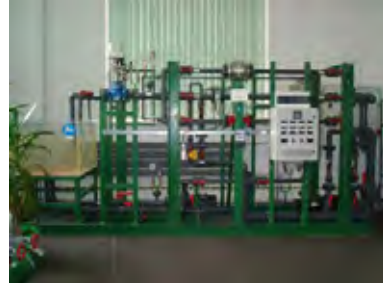
ポンプ実習設備
