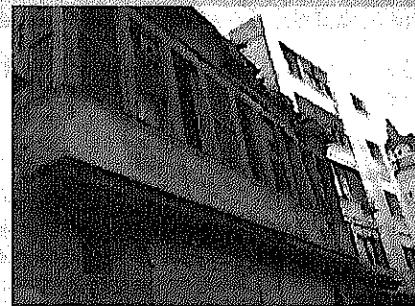
Un edificio envejecido en Qanawat Sur.
