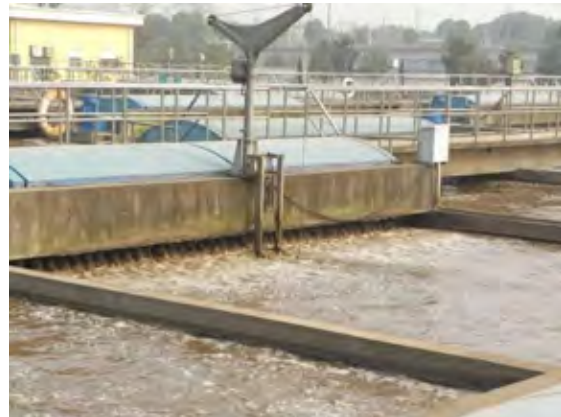
図 3 1-8)長沙第一汚水処理場拡張事業：OD (Oxidation Ditch) 法処理施設
