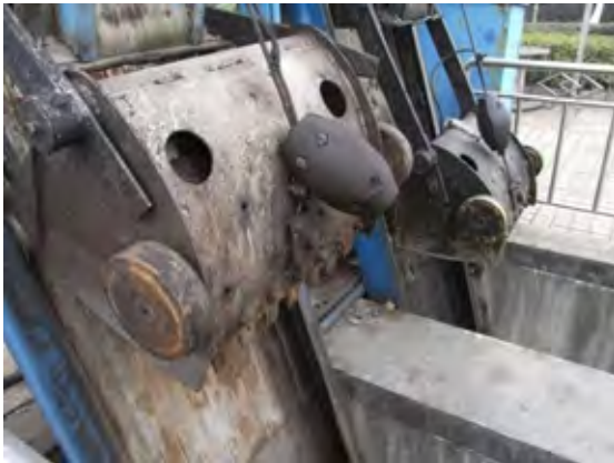
図 2 1-6)長沙開發区下水汚染対策：粗目スクリーン
