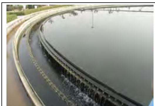
長沙第一污水处理場：最終沈澱池
