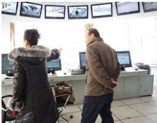
図 11 松原污水处理場の中央制御室
