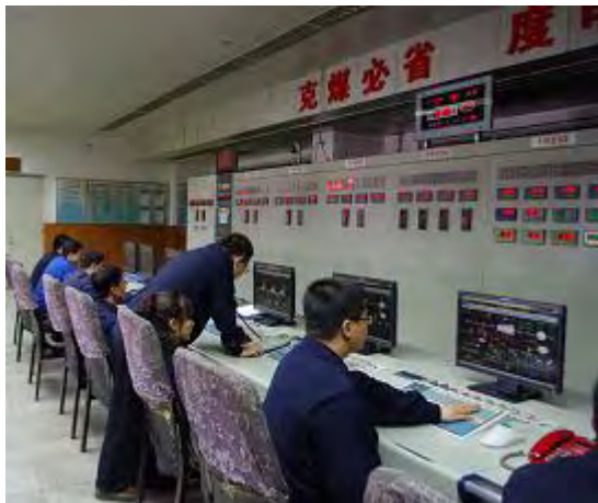
図 6 3-2.密山熱電供給の中央制御室
