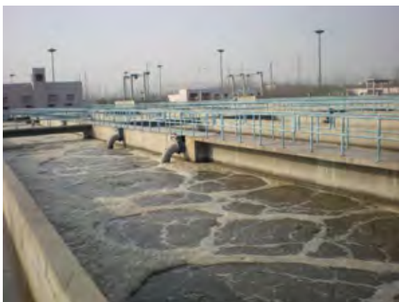
図 2 鄭州市下水処理場の反応タンク
