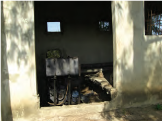
農民組合が運営しているポンプ場 (Bela Vista 近郊)
