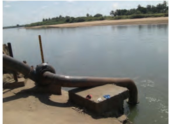
Licuingo riverに置かれたポンプ本体と吸水管の近影
