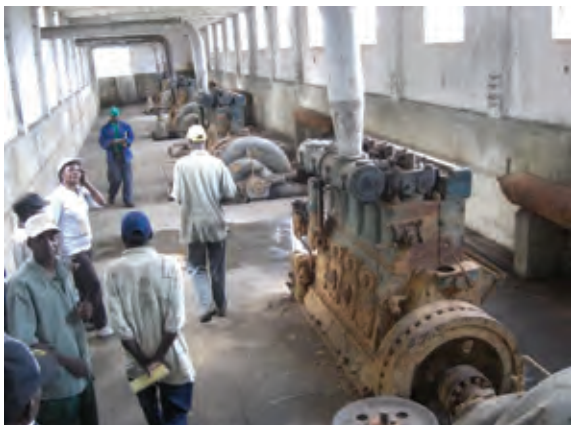
Nguri 地区 (1,000ha) の放棄されたポンプ場。北朝鮮の支援で1980年に完成した。14年後に、国営企業が崩壊し、維持運営ができなくなり、放置したまま。
