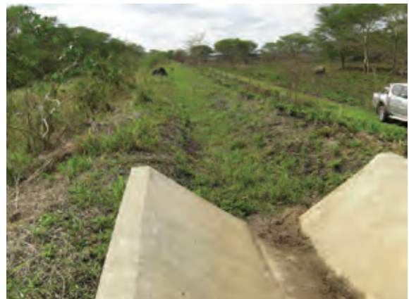
同左ポンプ場からの幹線水路は、漏水が激しく、利用できない (パイプを敷設して改修予定)。
