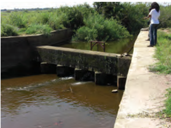
Munda-munda 地区（400ha）の洪水取水ゲート。流出防止のため、フラップゲートが着いている。オランダ政府が 3,000ha に拡張するための詳細設計資金を無償提供している。
