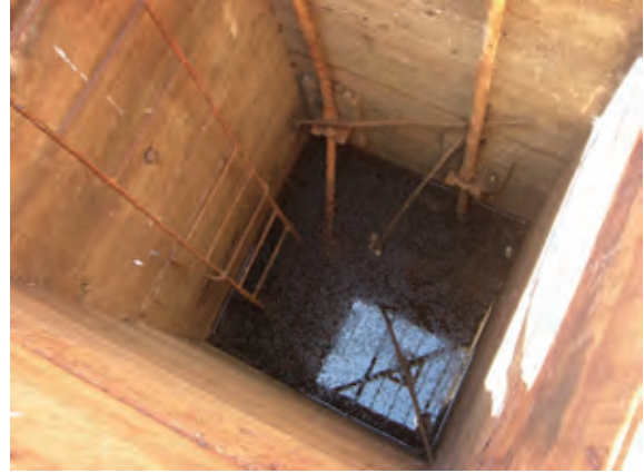
1987年に左岸取水ゲートが動作不能となる。それ以来23年間、ダムの取水は管理不能状態が続いている。
