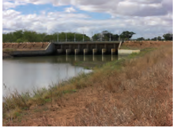
日本国無償資金協力で改修された幹線水路上の調整ゲート
