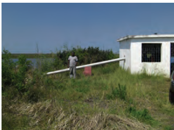
Dondo 県 Mandruzi 地区の低水頭ポンプとパイプ式の幹線水路は、2006 年に AfDB 資金で改修された。
