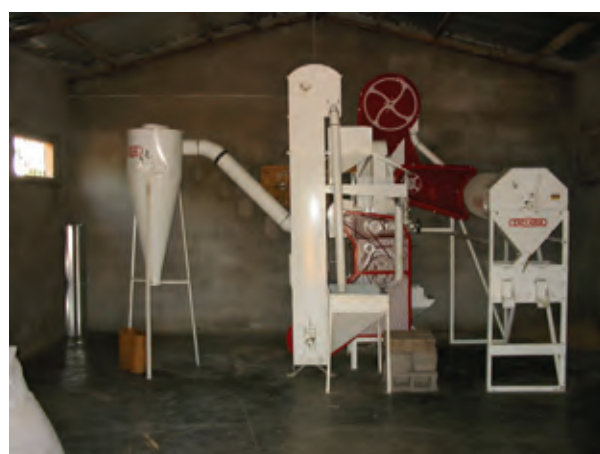
Associação Feminia の精米施設 (精米機はブラジルの Zaccaria 社製) (ザンベジア州 Maganja da Costa)
