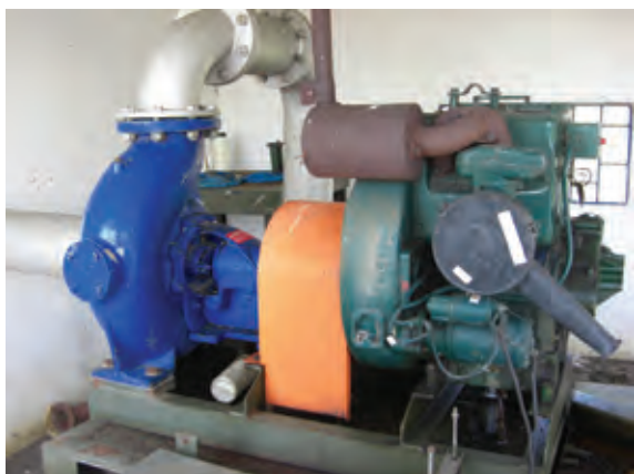
上のポンプ場にあるエンジンとポンプ一体型ユニット (60 リットル/sec)
