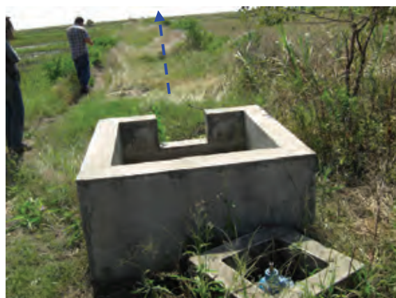
幹線水路からの分土工 (バルブが手前に見える) と二次水路 (矢印、草に覆われていて見えない)
