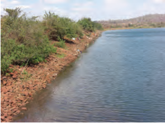
Chipembe 地区 (2,000ha) の水源施設であるダム。洪水吐が未完成であるが、貯水している。北朝鮮の支援で建設した。
