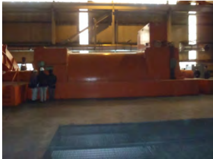
Hình 2.2-9 Máy phát điện Phả Lại II
