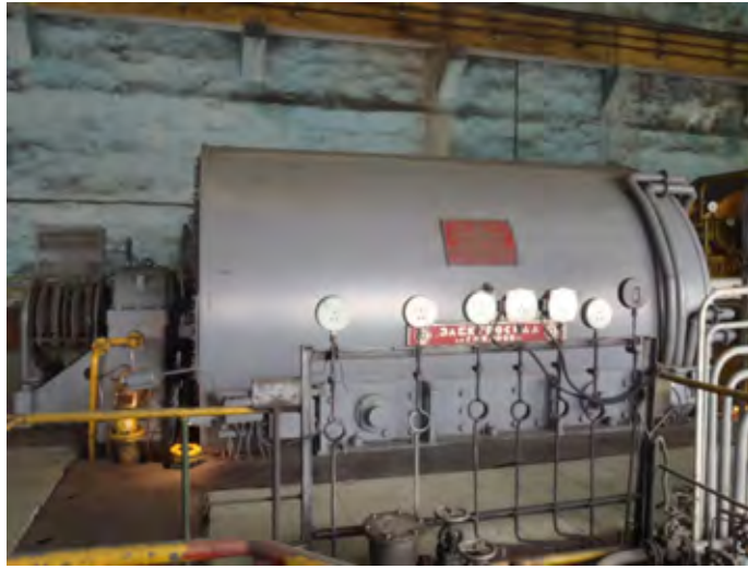
Hình 3.2-4 Máy phát điện tổ máy Uông Bí số 5, 6
