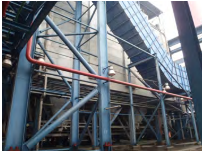
Hình 3.4-3 Máy lọc bụi tĩnh điện ở tổ máy Uông Bí số 7
