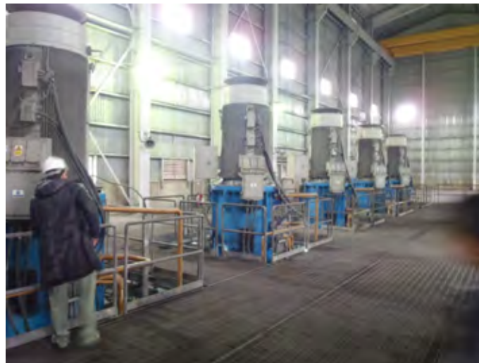
Hình 2.3-34 Máy bơm nước tuần hoàn nhà máy Phả Lại II
