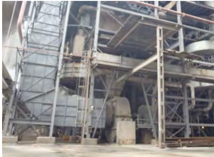
Hình 2.3-19 Quạt thông gió đẩy nhà máy Phả Lại I
