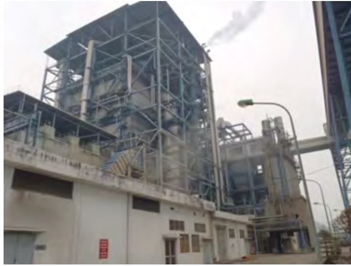
Hình 3.2-6 Hình ảnh lò hơi tổ máy Ung Bí số 7
