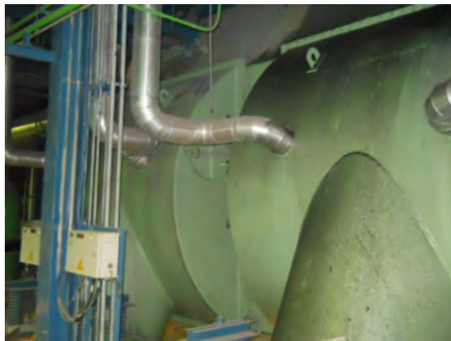
Hình 3.5-7 Tổ máy số 7 nhà máy Uông Bí - Bình ngưng
