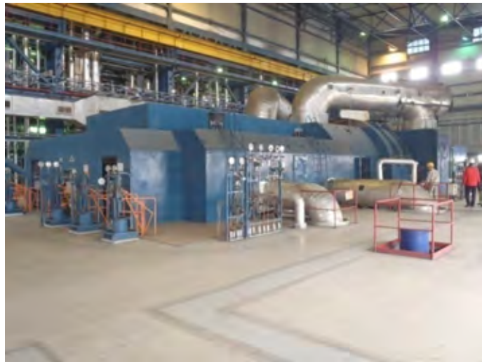
Hình 3.2-7 Hình ảnh tuabin, máy phát điện tổ máy Ung Bí số 7
