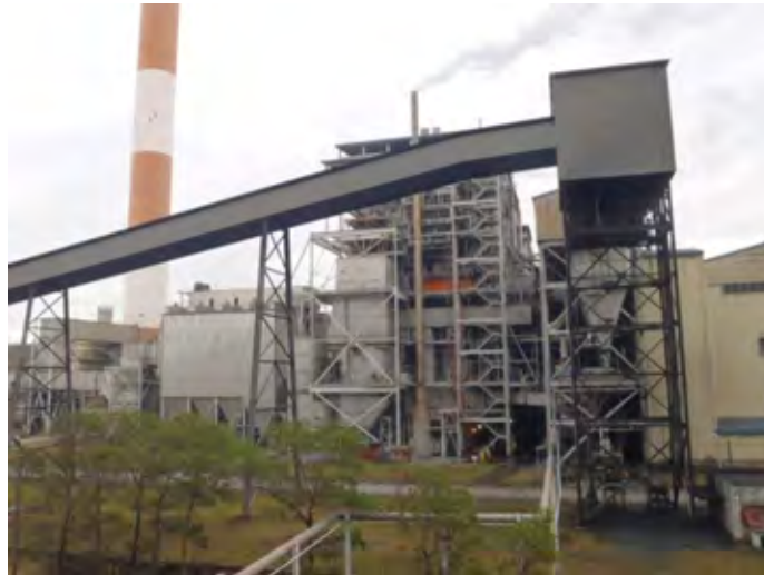
Hình 2.2-6 Hình ảnh lò hơi nhà máy Phả Lại II
