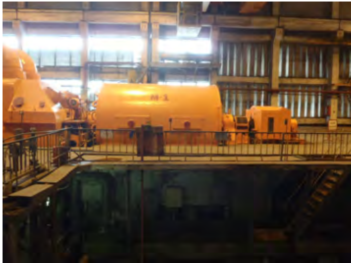
Hình 2.2-4 Máy phát điện Phả Lại I
