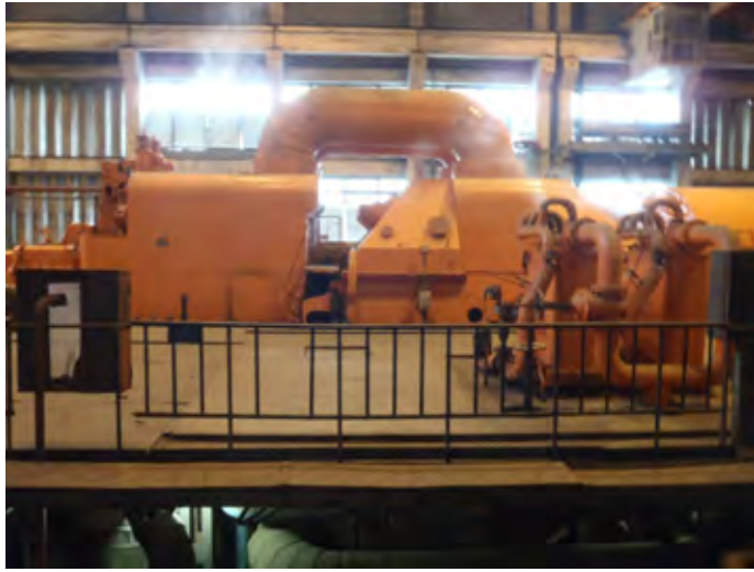
Hình 2.2-3 Tuabin nhà máy Phả Lại I
