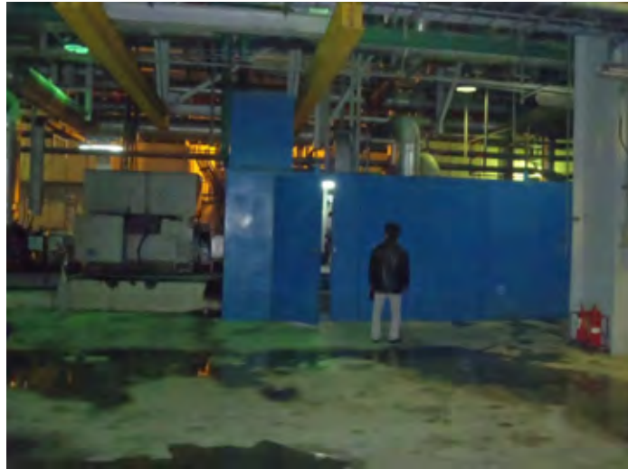
Hình 2.3-39 Máy bơm cấp nước lò hơi nhà máy Phả Lại II
