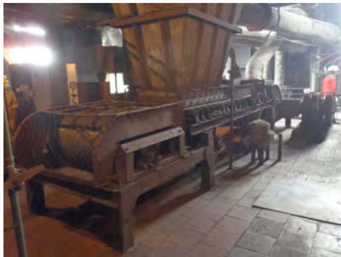
Hình 3.3-14 Máy cấp than Tổ máy Uông Bí số 5, 6
