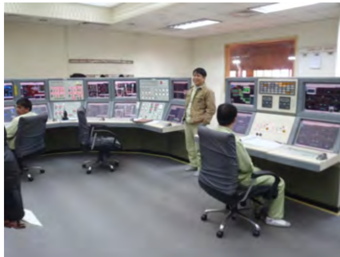
Hình 2.2-10 Phòng điều khiển nhà máy Phả Lại II
