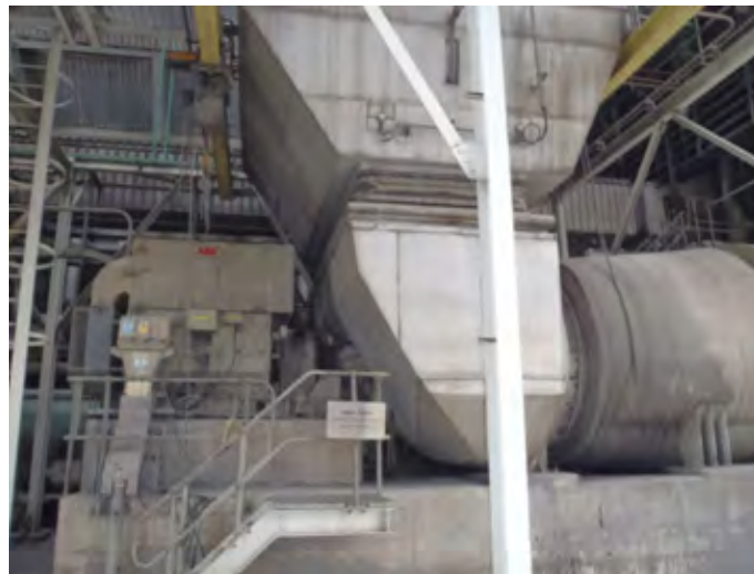
Hình 2.3-20 Quạt thông gió đẩy nhà máy Phả Lại II
