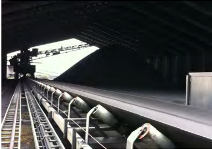
Hình 2.3-9 Băng tải trong kho trữ than
