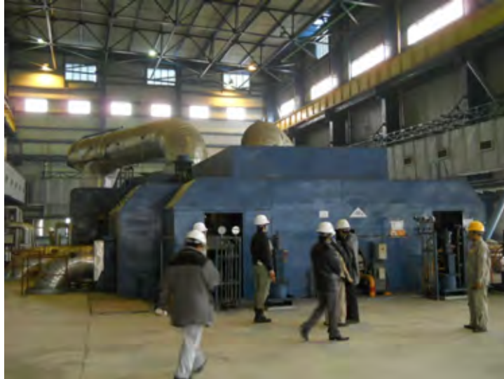
Hình 3.5-2 Tổ máy số 7 nhà máy Uông Bí - Thiết bị chính trong phòng
