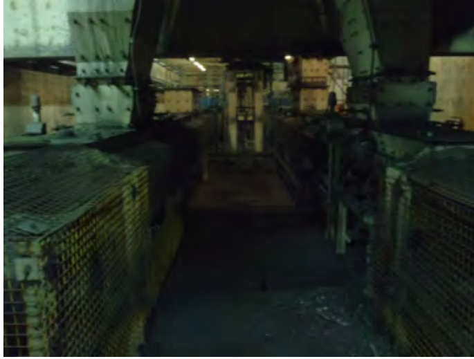
Hình 3.3-5 Tình trạng băng tải than dưới mặt đất
