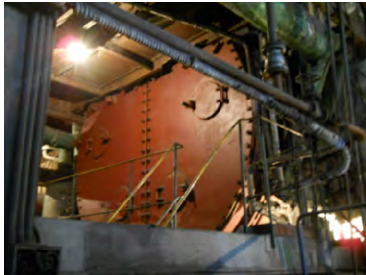
Hình 3.5-6 Tổ máy số 5, 6 nhà máy Uông Bí - Bình ngưng
