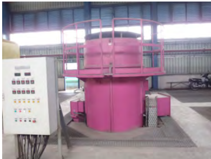
Hình 3.3-34 CWP của tổ máy Uông Bí số 5, 6
