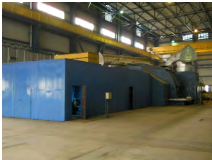
Hình 3.5-4 Tổ máy số 7 nhà máy Uông Bí - Tuabin chính
