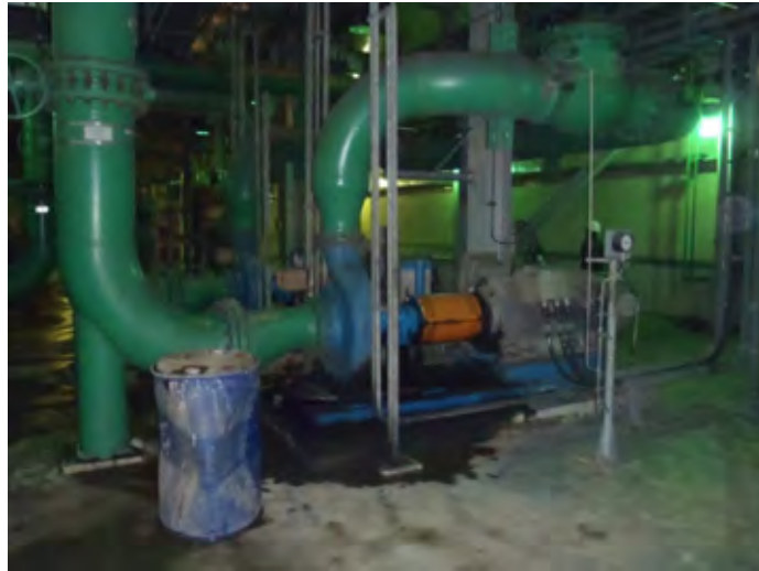
Hình 2.3-37 Máy bơm tăng áp nước ngưng tụ nhà máy Phả Lại II
