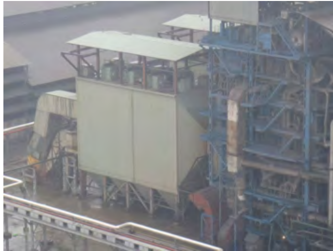
Hình 3.4-2 Máy lọc bụi tĩnh điện ở tổ máy Uông Bí số 5, 6
