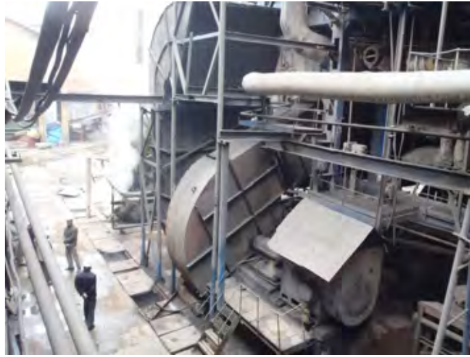
Hình 3.3-23 Quạt thông gió đẩy ở tổ máy Uông Bí số 5, 6
