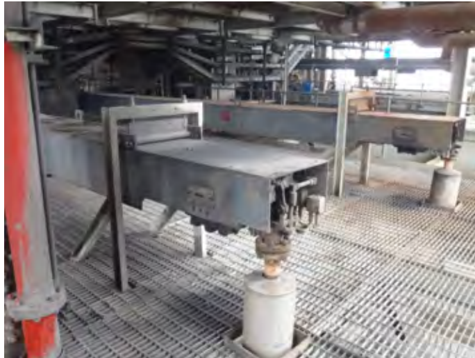
Hình 2.3-26 Quạt thổi muội than kiểu xoay của lò hơi nhà máy Phả Lại I và Phả Lại II
