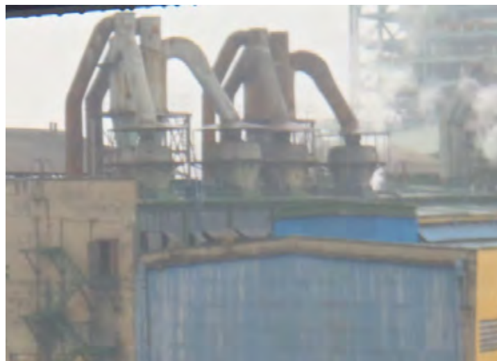
Hình 3.3-18 Máy phân ly cyclone của tổ máy Uông Bí số 5, 6
