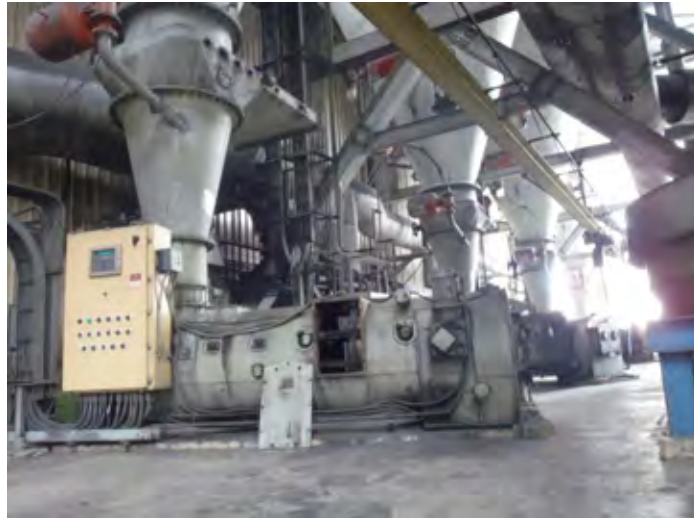
Hình 2.3-13 Máy cấp than ở nhà máy Phả Lại I
