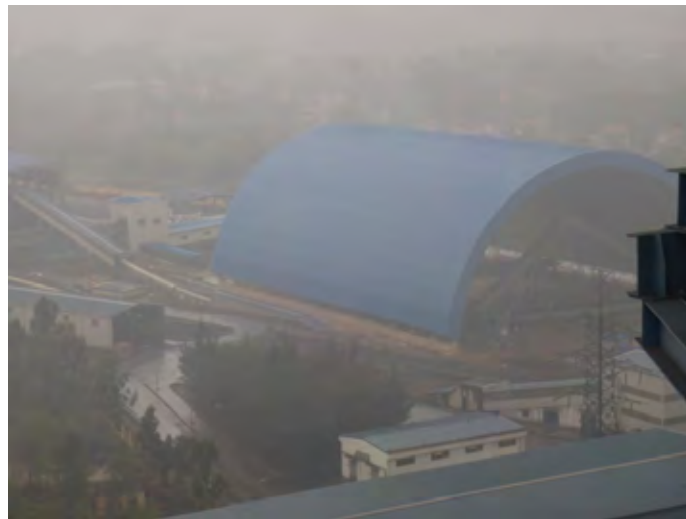
Hình 3.3-8 Kho trữ than trong nhà kiểu mái vòm dùng cho tổ máy Uông Bí số 8 (đang xây dựng)
