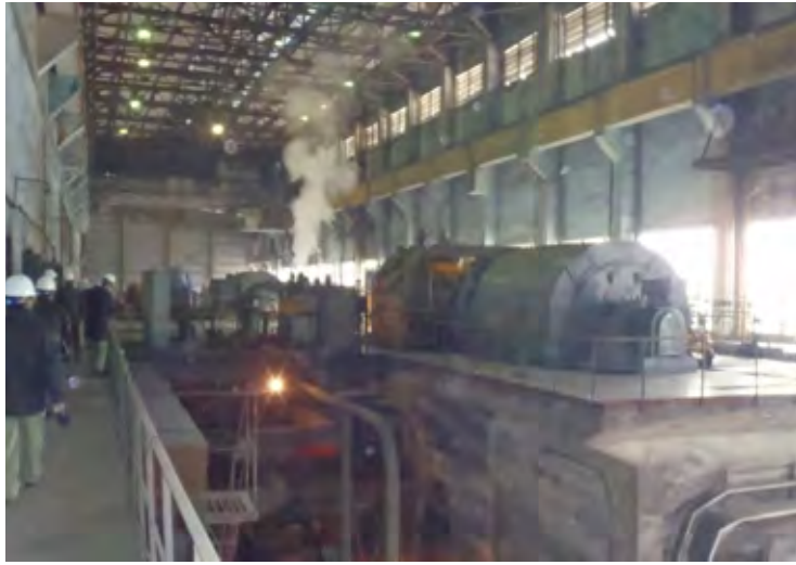
Hình 3.2-2 Hình ảnh tuabin, máy phát điện tổ máy Uông Bí số 5, 6
