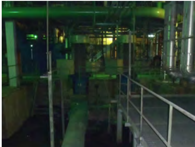
Hình 2.3-36 Máy bơm nước ngưng tụ nhà máy Phả Lại II
