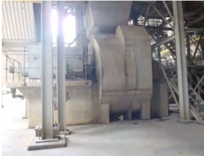
Hình 2.3-21 Quạt đẩy không khí sơ cấp nhà máy Phả Lại II
