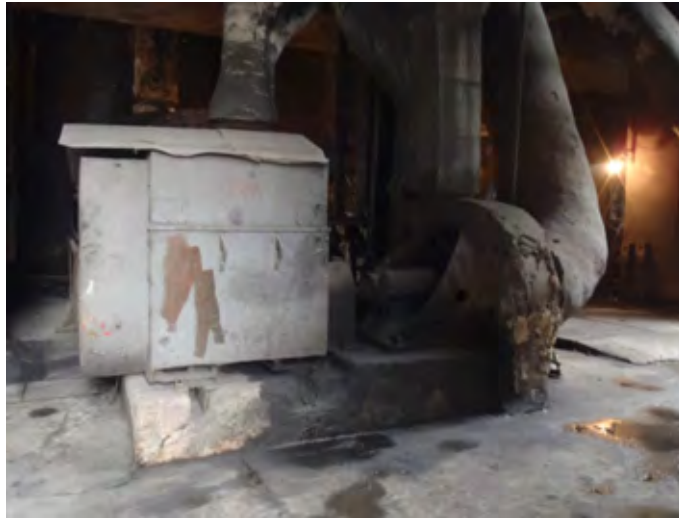
Hình 3.3-21 Máy cấp than bột ở tổ máy Uông Bí số 5, 6
