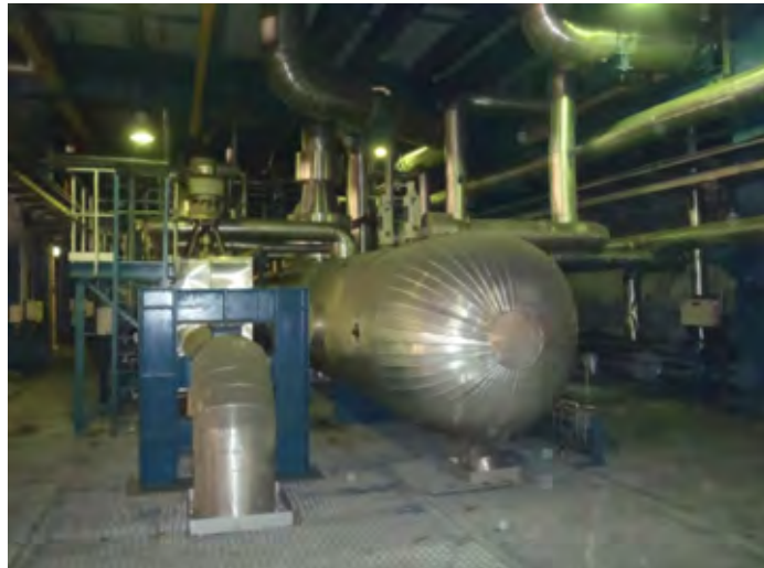
Hình 3.3-38 Bình gia nhiệt nước cấp tổ máy Uông Bí số 7
