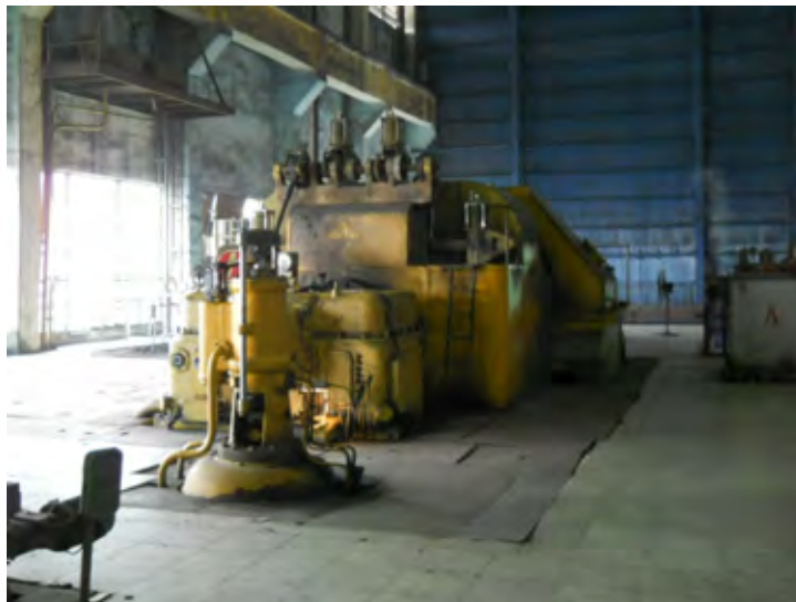
Hình 3.5-3 Tổ máy số 5, 6 nhà máy Uông Bí - Tuabin chính
