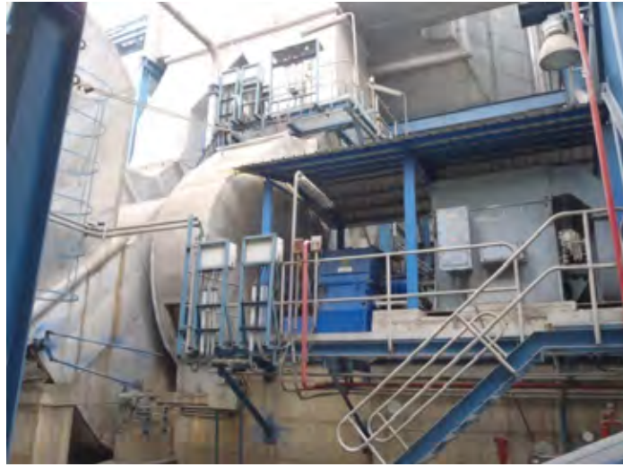
Hình 3.3-25 Quạt đẩy không khí sơ cấp ở tổ máy Uông Bí số 7
