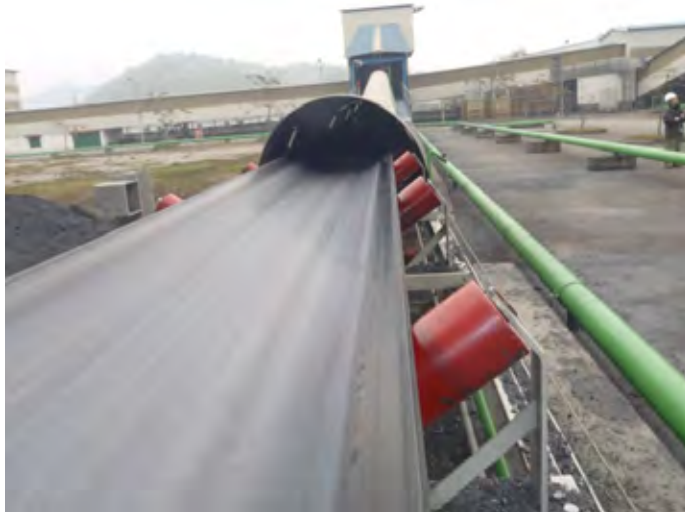
Hình 3.3-10 Băng tải vận chuyển than
