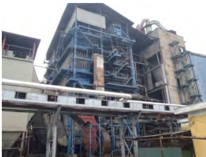
Hình 3.2-1 Hình ảnh lò hơi tổ máy Uông Bí số 5, 6
