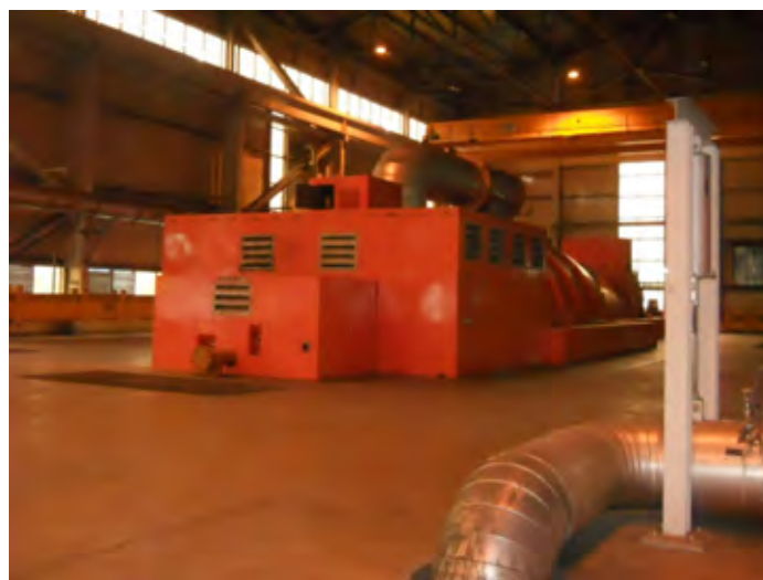
Hình 2.5-2 Nhà máy Phả Lại II Tuabin trong nhà
