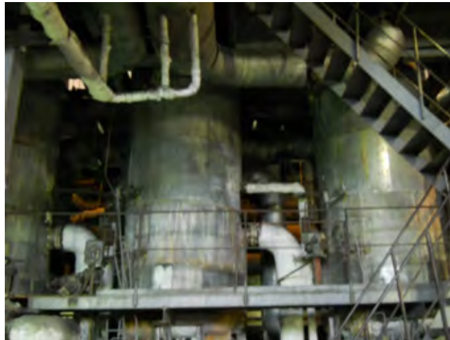
Hình 2.5-5 Nhà máy Phả Lại I Bộ gia nhiệt nước cấp
