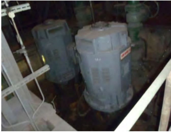
Hình 2.3-35 Máy bơm nước ngưng tụ nhà máy Phả Lại I
