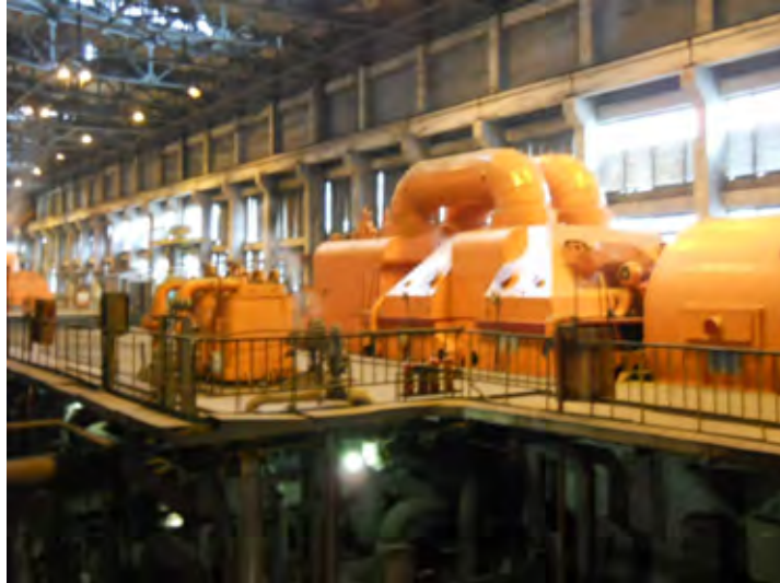
Hình 2.5-1 Nhà máy Phả Lại I Tuabin trong nhà
