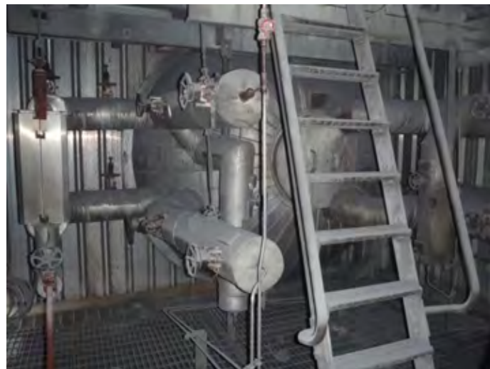
Hình 2.3-40 Bao hơi tại nhà máy Phả Lại II
