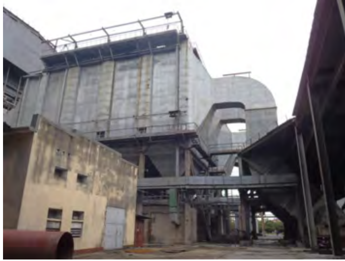
Hình 2.4-2 Máy lọc bụi tĩnh điện nhà máy Phả Lại I
