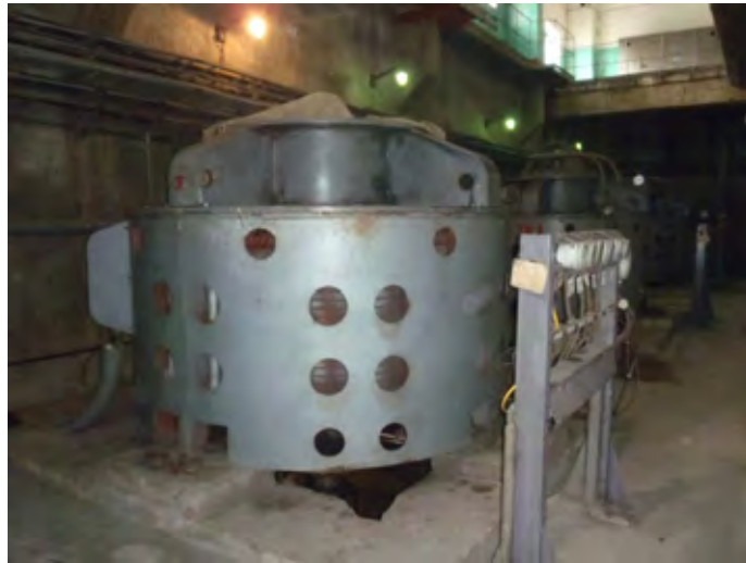
Hình 2.3-33 Máy bơm nước tuần hoàn nhà máy Phả Lại I
