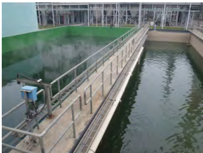
Hình 2.4-5 Bể chứa nước thải
