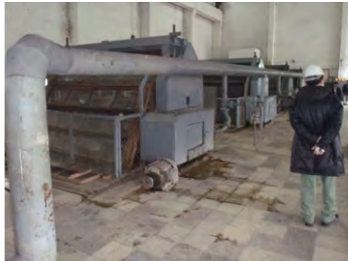
Hình 2.3-30 Tấm chắn dạng quay nhà máy Phả Lại I
