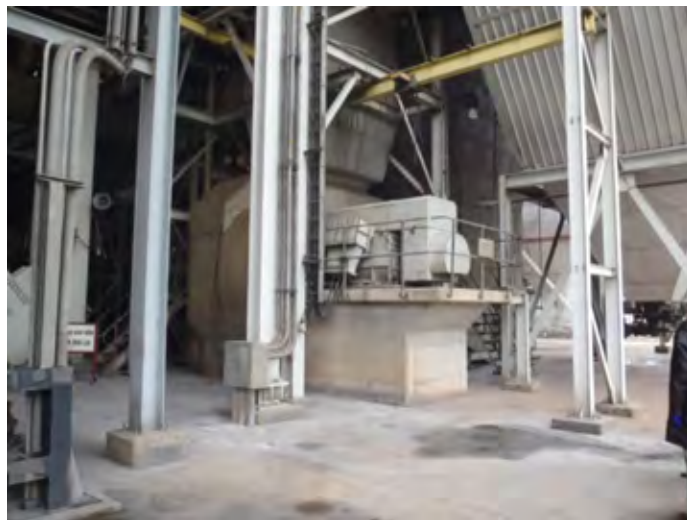
Hình 2.3-18 Quạt cấp bột than nhà máy Phả Lại II
