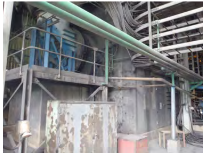
Hình 2.3-16 Máy nghiền than dạng ống nhà máy Phả Lại II
