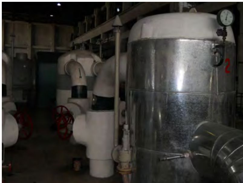
Hình 1.5-3 Bộ gia nhiệt nước cấp
