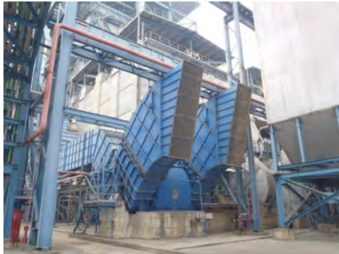
Hình 3.3-24 Quạt thông gió đẩy ở tổ máy Uông Bí số 7
