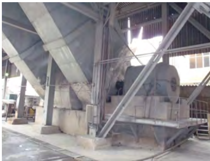
Hình 2.3-22 Quạt hút nhà máy Phả Lại I
