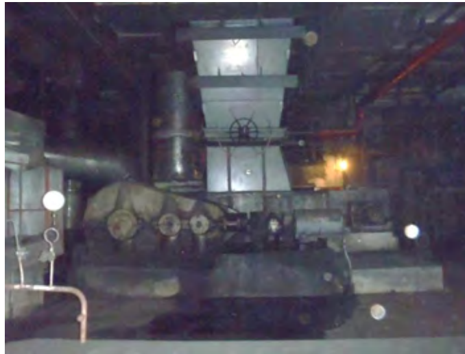
Hình 2.3-14 Máy cấp than ở nhà máy Phả Lại II
