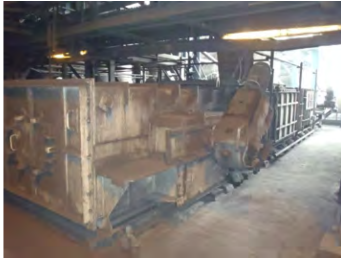
Hình 3.3-15 Máy cấp than Tổ máy Uông Bí số 7
