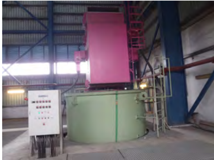
Hình 3.3-35 CWP của tổ máy Uông Bí số 7
