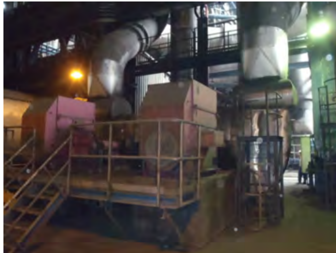
Hình 3.3-22 Máy cấp than bột ở tổ máy Uông Bí số 7
