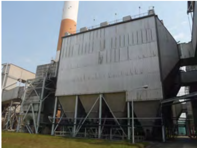
Hình 2.4-3 Máy lọc bụi tĩnh điện nhà máy Phả Lại II
