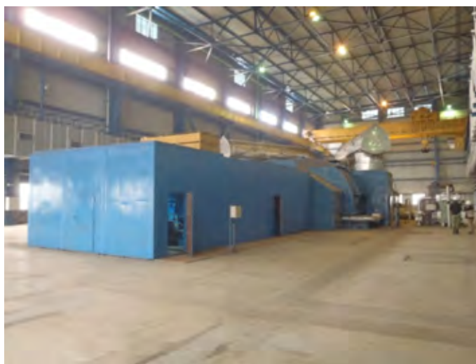
Hình 3.2-9 Máy phát điện tổ máy Uông Bí số 7
