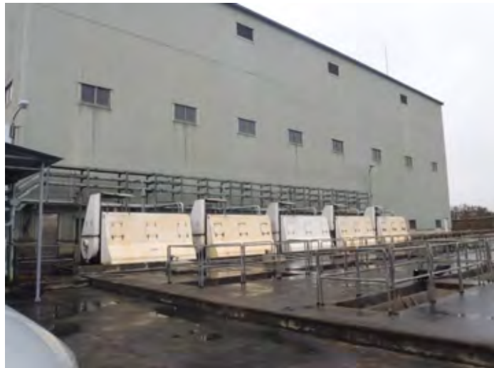
Hình 2.3-32 Tấm chắn dạng quay nhà máy Phả Lại II
