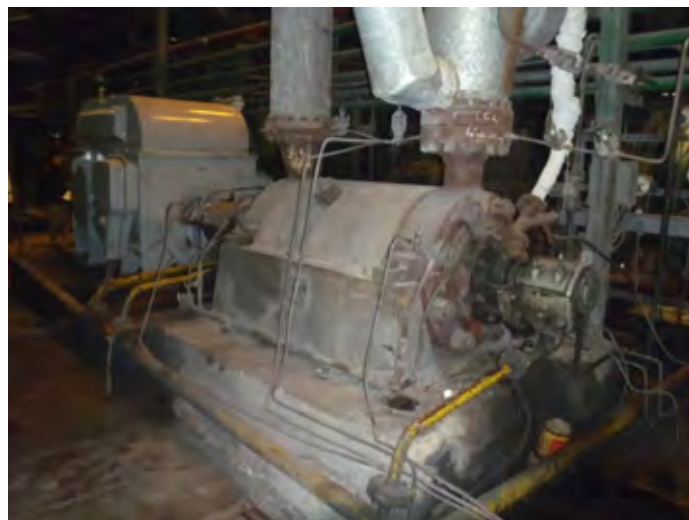
Hình 2.3-38 Máy bơm cấp nước lò hơi nhà máy Phả Lại I
