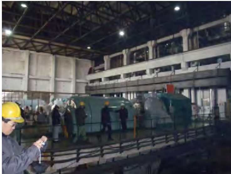
Hình 1.2-1 Tua bin và máy phát điện
