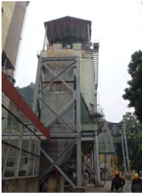
Hình 1.4-2 Hệ thống máy lọc bụi tĩnh điện khô
