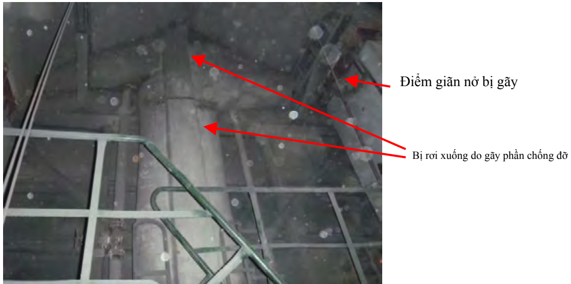
Hình 2.2-5 Đường dẫn bị hư hại
