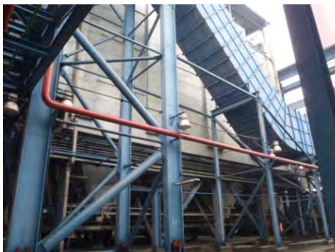
図 3.4-3 Uong Bi 7号機 電気集塵器
