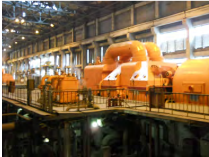
図 2.5-1 Pha Lai I タービン建屋内
