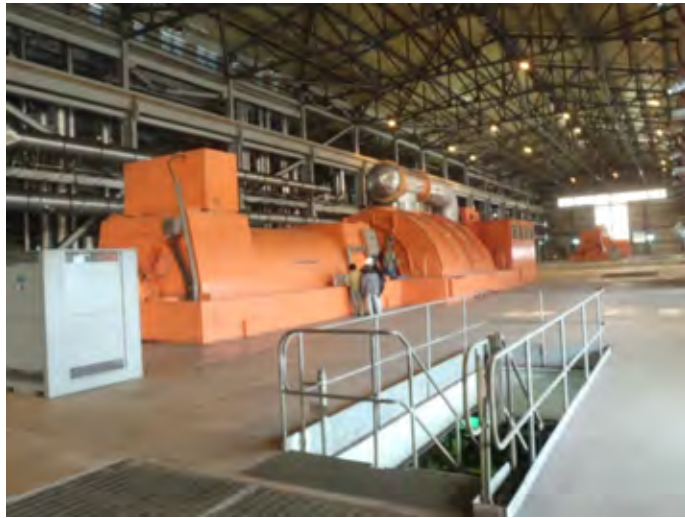
図 2.2-7 Pha Lai II タービン、発電機外観
