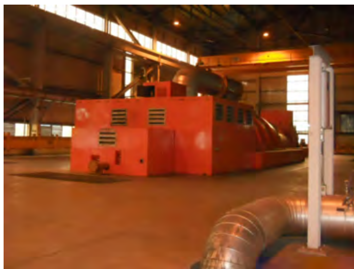
図 2.5-2 Pha Lai II タービン建屋内
