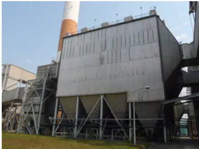
図 2.4-3 Pha Lai II 電気集塵器
