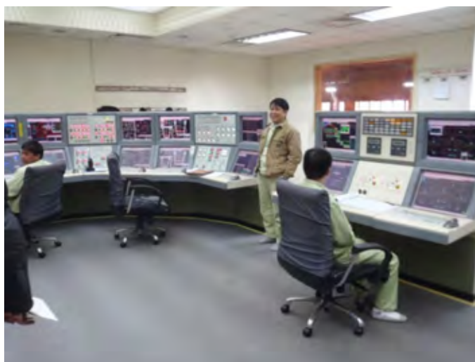
図 2.2-10 Pha Lai II 制御室
