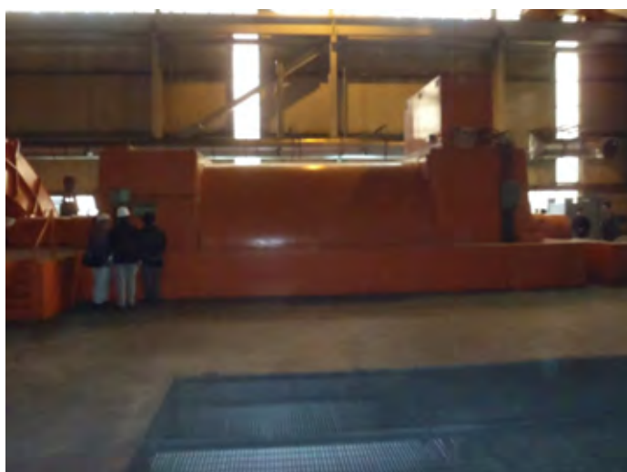
図 2.2-9 Pha Lai II 発電機
