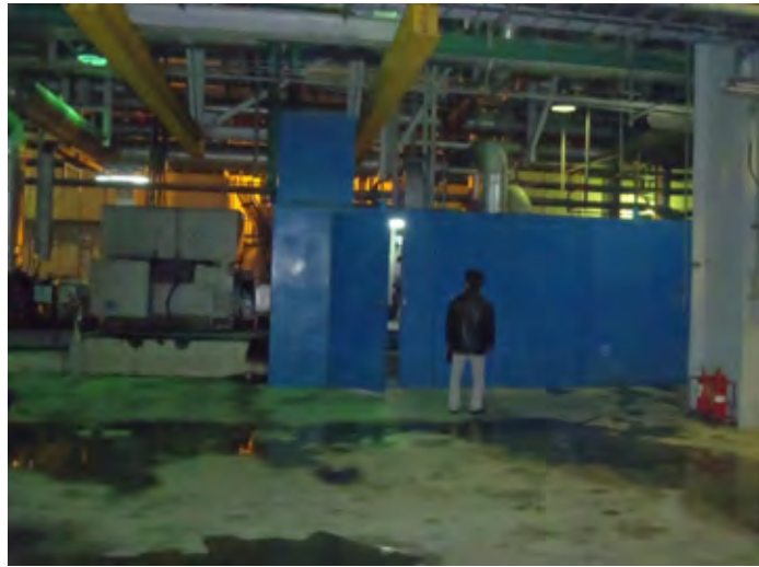
図 2.3-39 Pha Lai II ボイラ給水ポンプ
