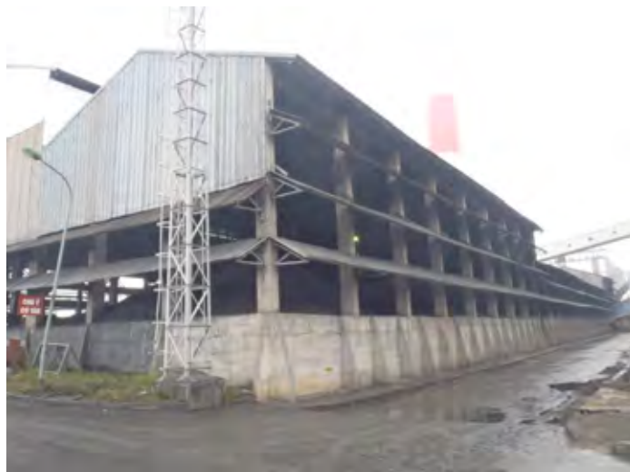
図 3.3-6 Uong Bi 5,6号機の屋内貯炭場
