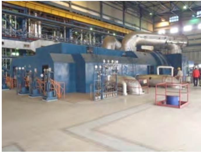
図 3.2-7 Uong Bi 7 タービン、発電機外観
