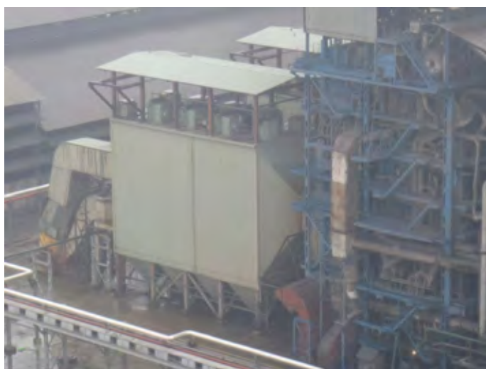
図 3.4-2 Uong Bi 5,6号機 電気集塵器
