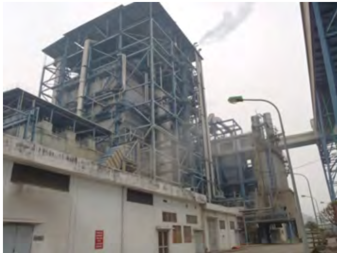
图 3.2-6 Uong Bi 7 ボイラ外観
