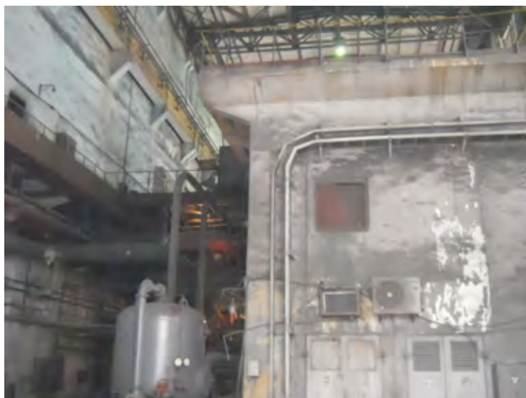
図 3.5-1 Uong Bi 5,6 号機 本館建屋内（タービン基礎回り）
