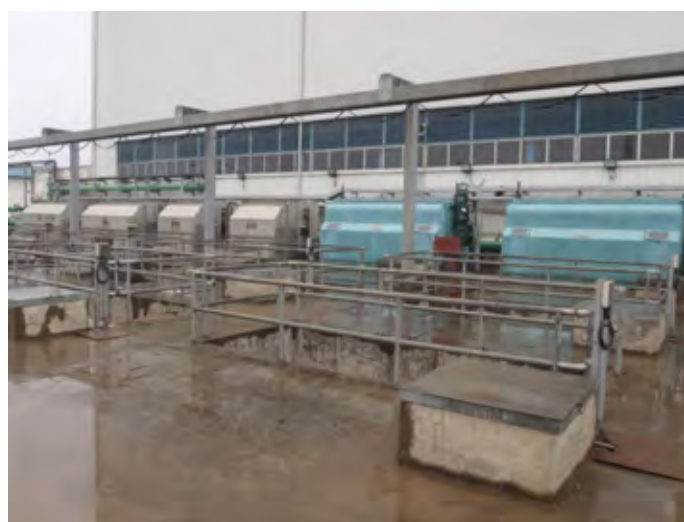
図 3.3-32 ロータリスクリーン (写真左より2台が7号機用、真ん中2台が5,6号機用、右端の青い2台は建設中8号機用)
