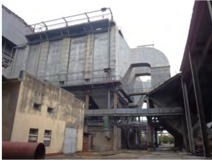
図 2.4-2 Pha Lai I 電気集塵器
