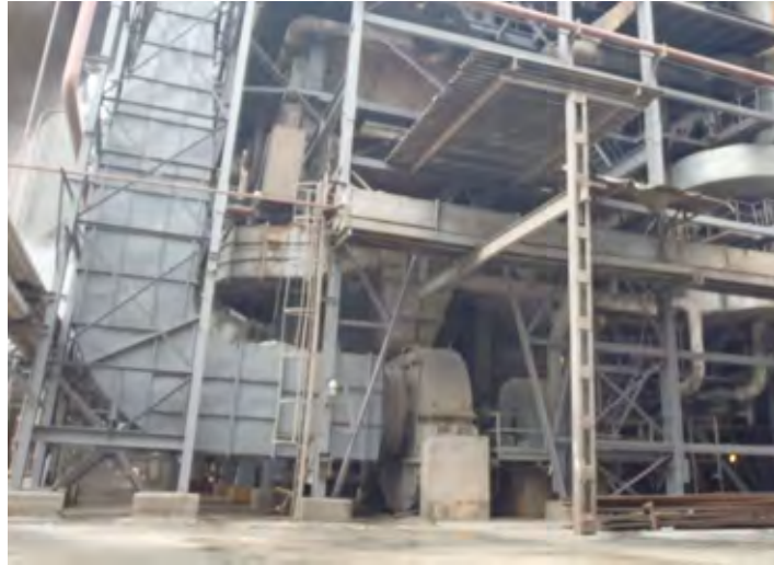
図 2.3-19 Pha Lai I 押込通風ファン
