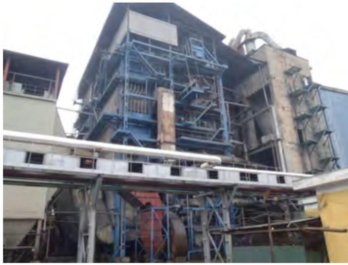
図 3.2-1 Uong Bi 5,6 ボイラ外観
