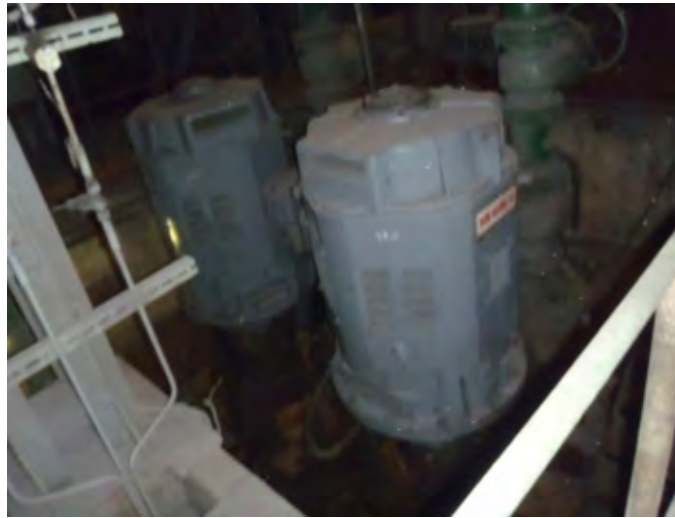
図 2.3-35 Pha Lai I 復水ポンプ
