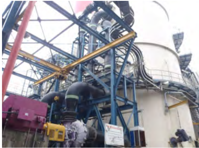
図 3.4-4 Uong Bi 7号機 排煙脱硫装置
