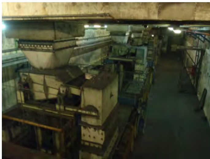
図 3.3-4 地下の受入コンベヤ
