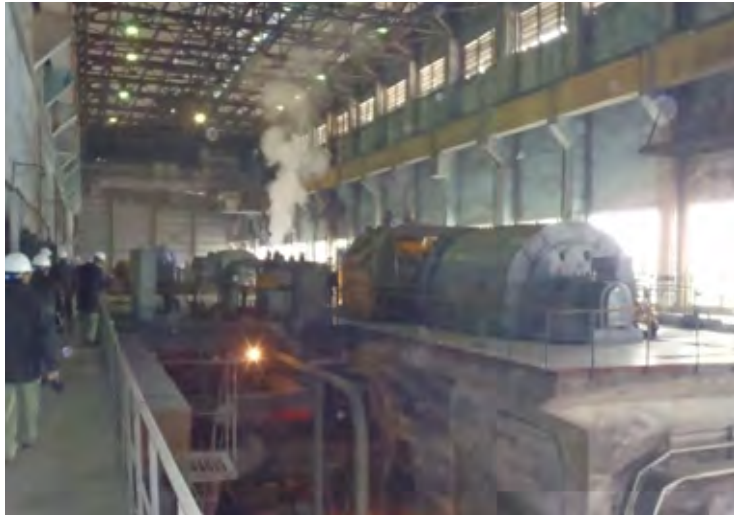
図 3.2-2 Uong Bi 5,6 タービン、発電機外観
