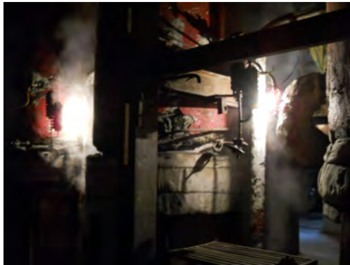
図 3.5-5 Uong Bi 5,6 号機 給水加熱器まわり
