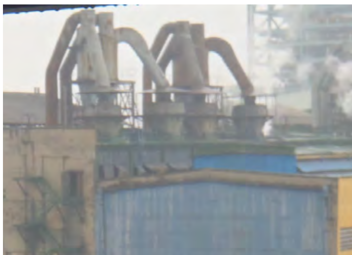
図 3.3-18 Uong Bi 5,6号機 サイクロン分離器
