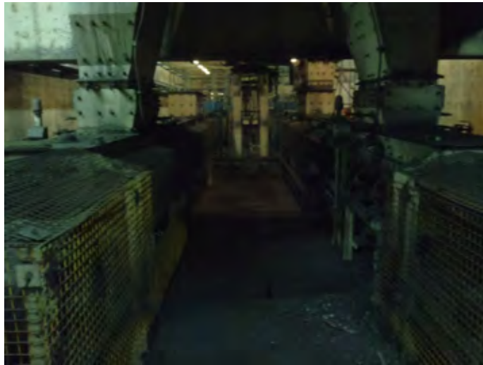
図 3.3-5 地下の受入コンベヤ状況
