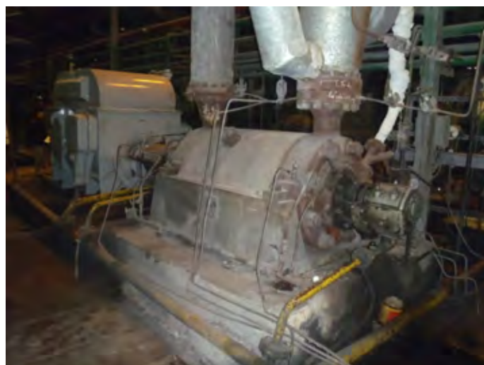
図 2.3-38 Pha Lai I ボイラ給水ポンプ
