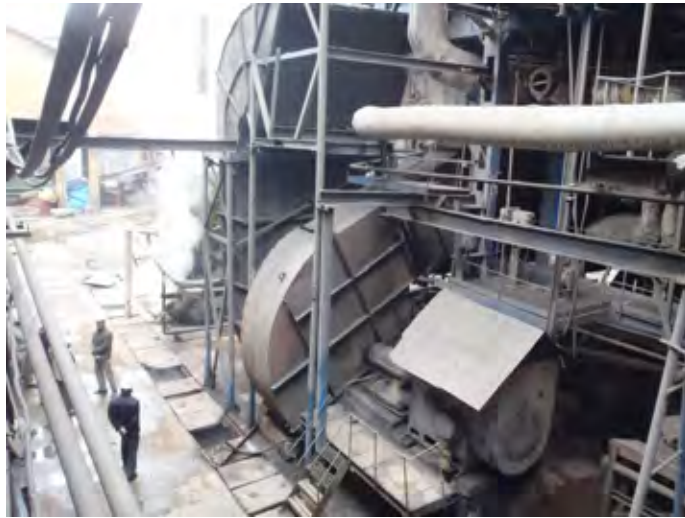
図 3.3-23 Uong Bi 5,6号機 押込通風ファン
