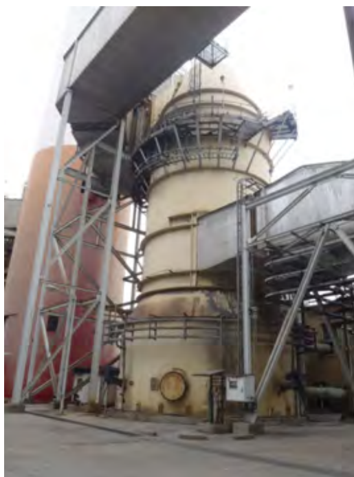
図 2.4-4 湿式排煙脱硫装置
