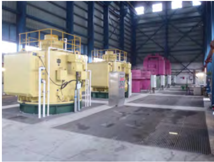
図 3.3-33 ポンプ場全景 (写真左、黄色の CWP は建設中の 8 号機用)
