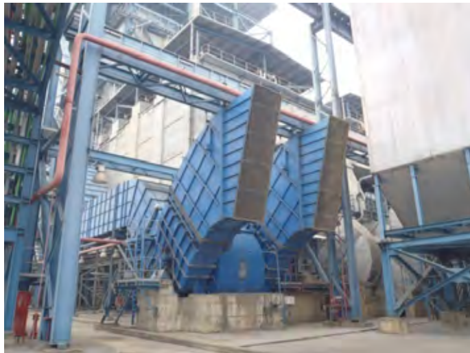
図 3.3-24 Uong Bi 7号機 押込通風ファン
