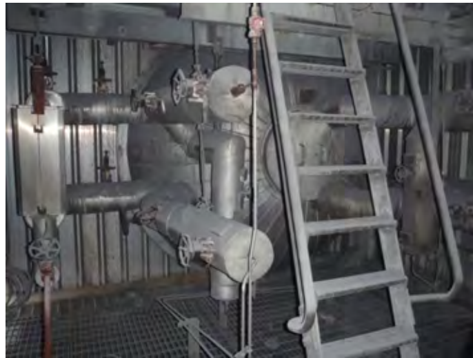
図 2.3-40 Pha Lai II の蒸気ドラム
