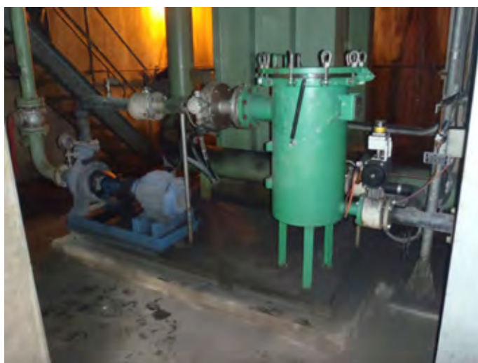
図 2.3-41 復水器洗浄装置
