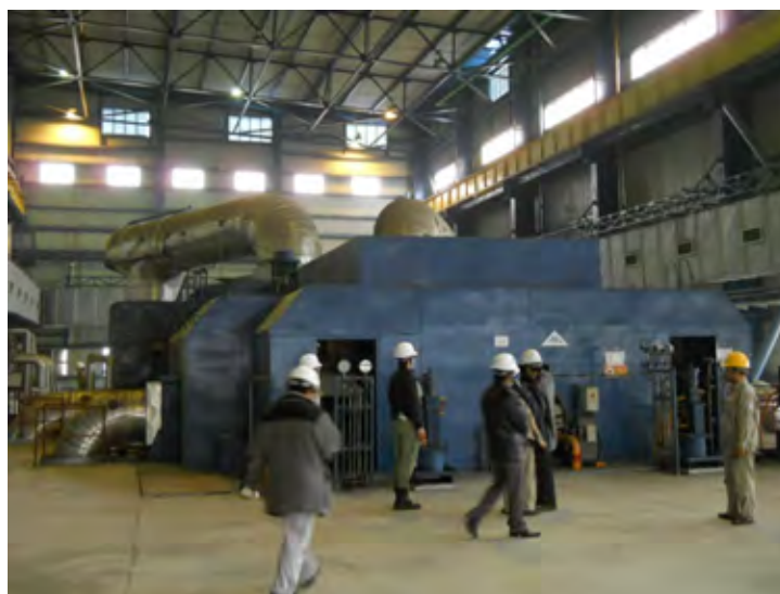
図 3.5-2 Uong Bi 7 号機 本館建屋内
