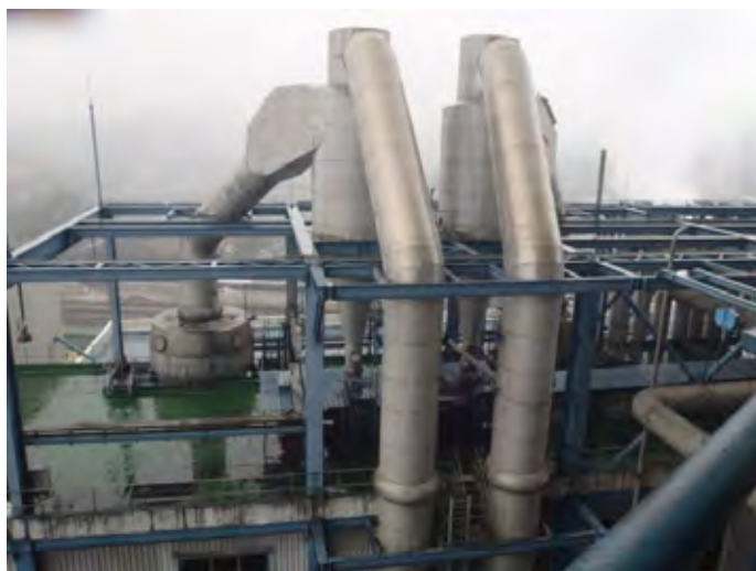
図 3.3-20 Uong Bi 7号機 サイクロン分離器
