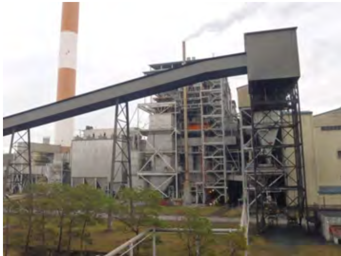
図 2.2-6 Pha Lai II ボイラ外観
