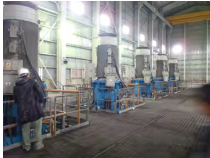
図 2.3-34 Pha Lai II 循環水ポンプ
