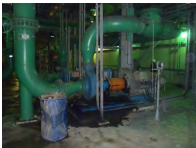
図 2.3-37 Pha Lai II 復水昇圧ポンプ
