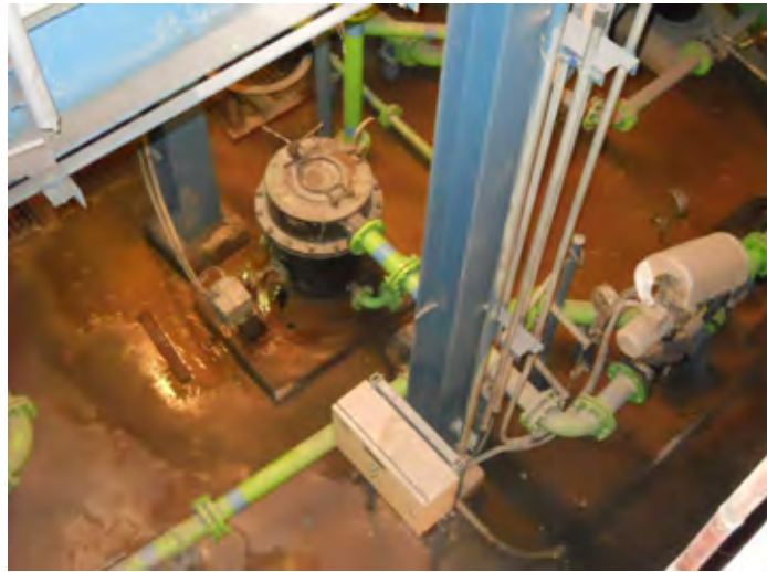
図 3.3-43 Uong Bi 7号機 復水器洗浄装置
