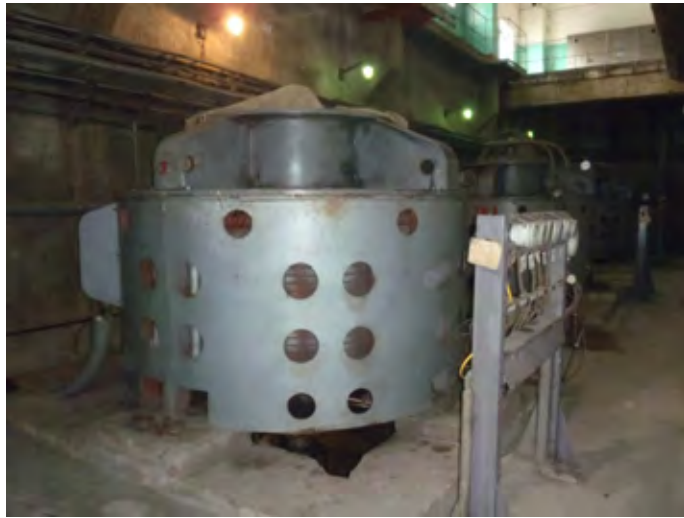
図 2.3-33 Pha Lai I 循環水ポンプ
