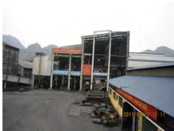
図 2.3-18 篩設備を設置した選炭工場
