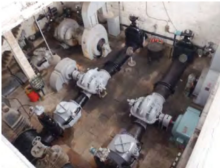
図 1.3-19 循環水ポンプ外観
