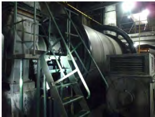
図 1.3-13 ミル運転状況
