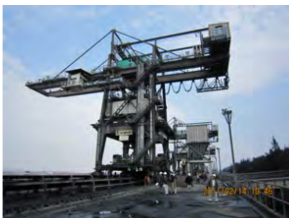
図 2.3-23 新荷卸し設備 (Pha Lai)
