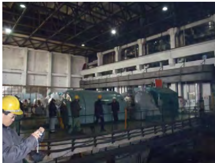
図 1.2-1 タービン、発電機
