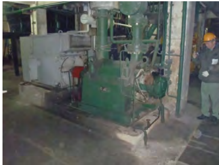
図 1.3-20 ボイラ給水ポンプ外観
