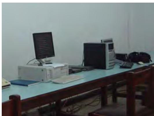
図 5-3-8 GTS 送受信装置
