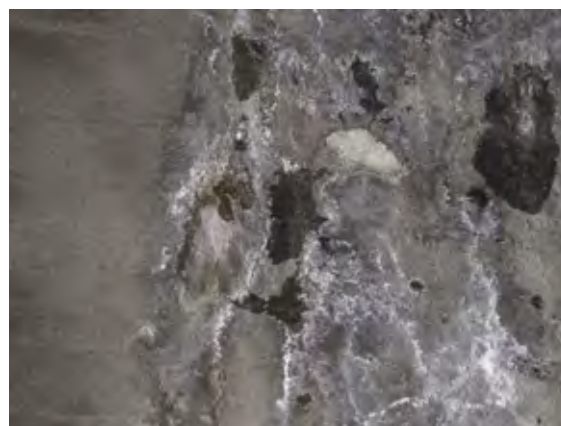
写真-3 トンネル No.1 吹付けコンクリート剥落状況（起点側坑口から 290m 付近）
