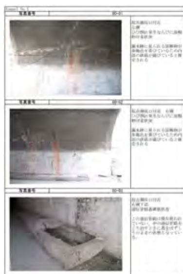
図 トンネル変状箇所写真帳
