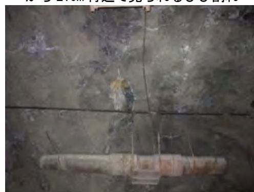
写真-10 トンネル No.2 起点側坑口から 250m 付近天端の崩落状況
