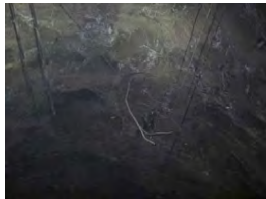
写真-5 トンネル No.1 ケーブルの垂れ下がり（起点側坑口から 250m 付近）
