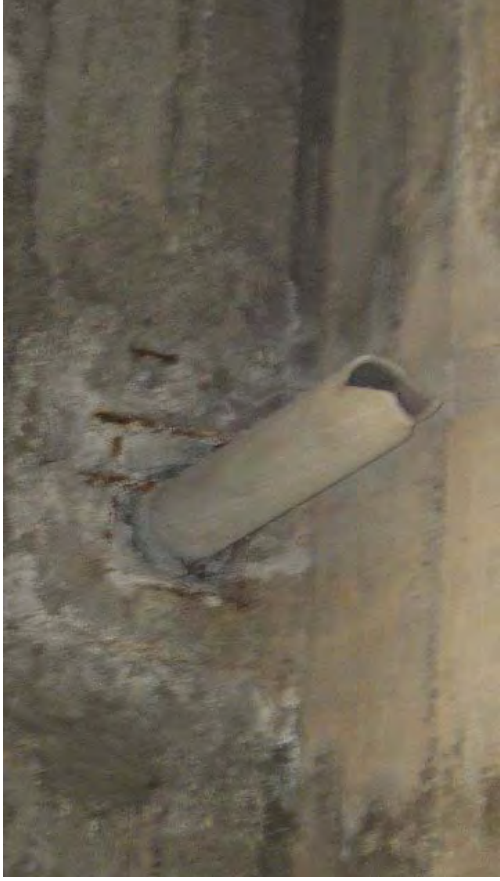
排水管の損傷と漏水によるスポーリングの進展状況。
