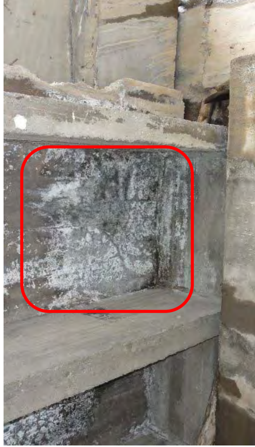
床版に広く見られる遊離石灰。
