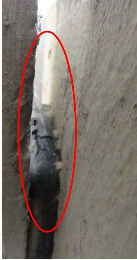
P2 橋脚横梁部に上部工より落ちてきたと思われる遊離石灰が大量に付着しており、漏水が多いことが示される。
