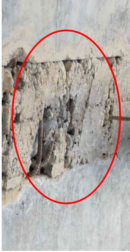
間詰コンクリートのハニカムの例。
