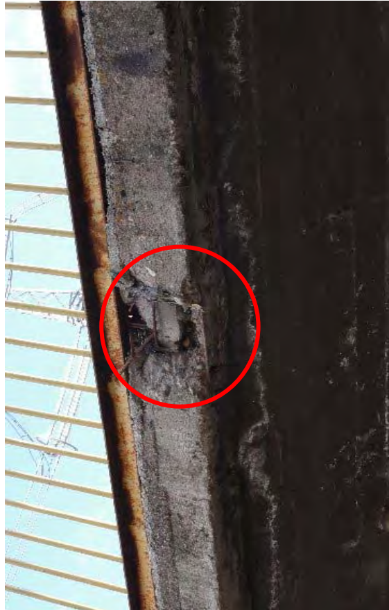
排水管には鋼管が用いられているが既に腐食しており、塗装が必要。
