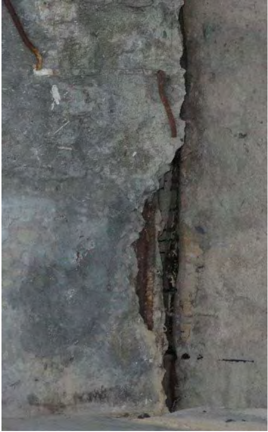
G1 桁と G2 桁間の A1 橋台側端部に鉄筋露出
