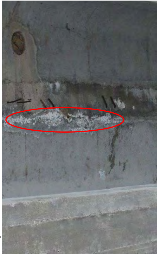
G1 桁と G2 桁間詰コンクリート部に遊離石灰が析出しており若干の漏水があることを示す。
