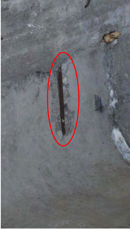
G1 桁上フランジ下面鉄筋露出 (長さ 1m x 幅 20cm x 深さ 40mm)
